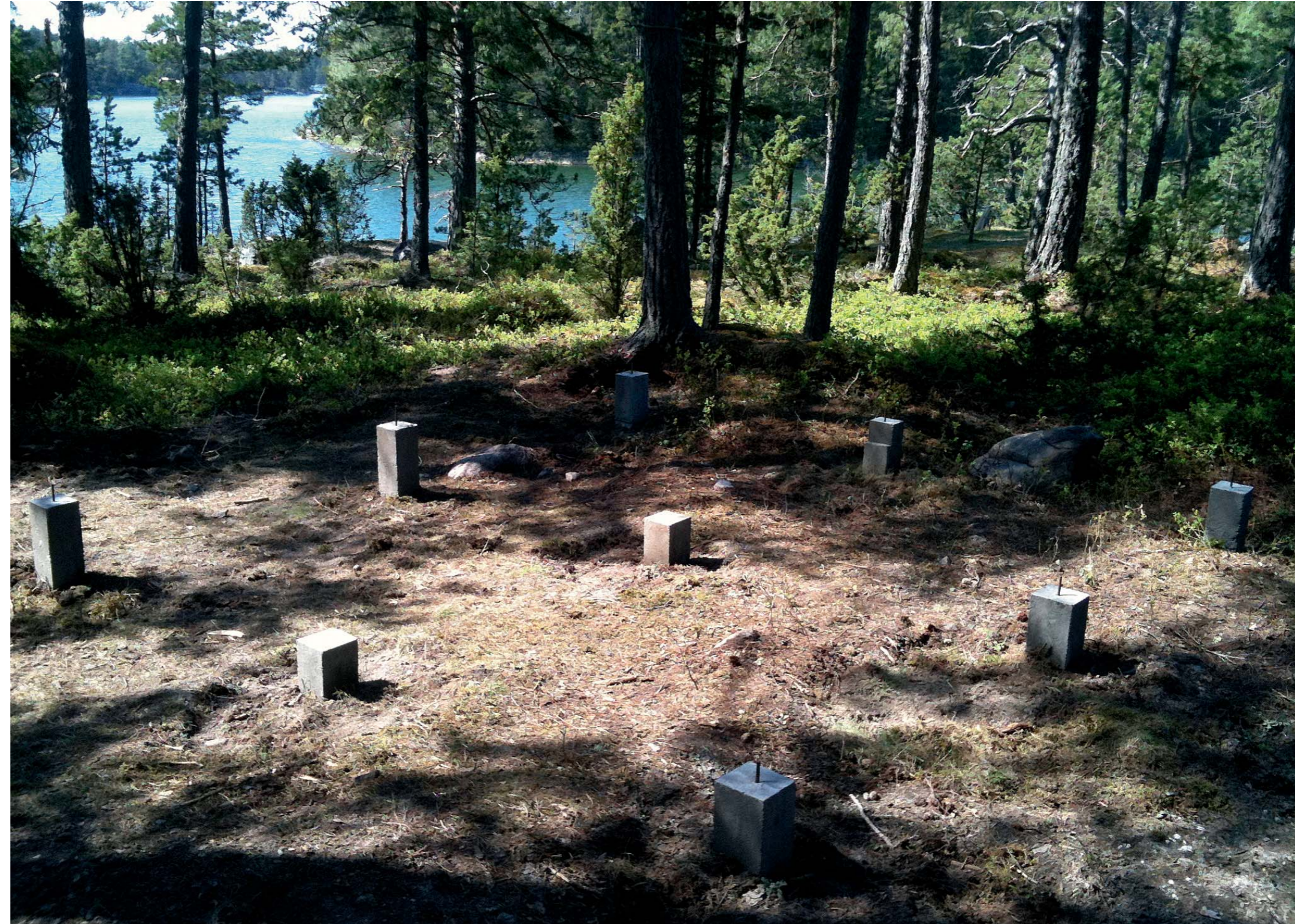
Mökki on perustettu kahdentoista betonipilarin päälle, jotka on valettu nk. jankko-maaperään. Jankko on tiivistynyt maakerros, jonka läpi vesi ei pääse tunkeutumaan (Vasama 2013). Tästä johtuen perustuksia haittaavaa routimista ei tapahdu.
