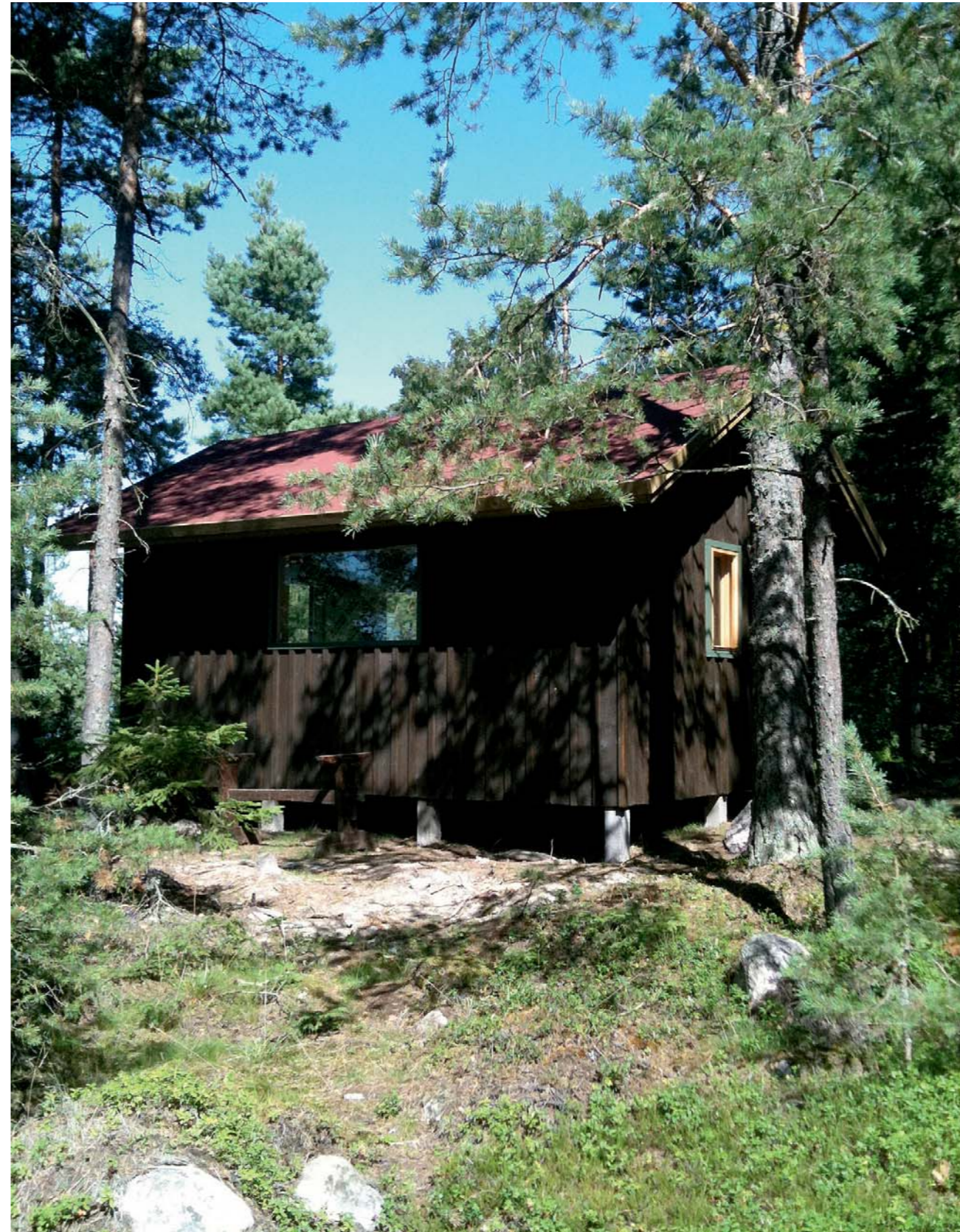
Kuvassa mökin kaakkoispääty, joka puretaan osittain ja johon laajennusosa liittyy. Maasto viettää voimakkaasti alaspäin, mikä ohjaa laajennusosan suunnittelua.
