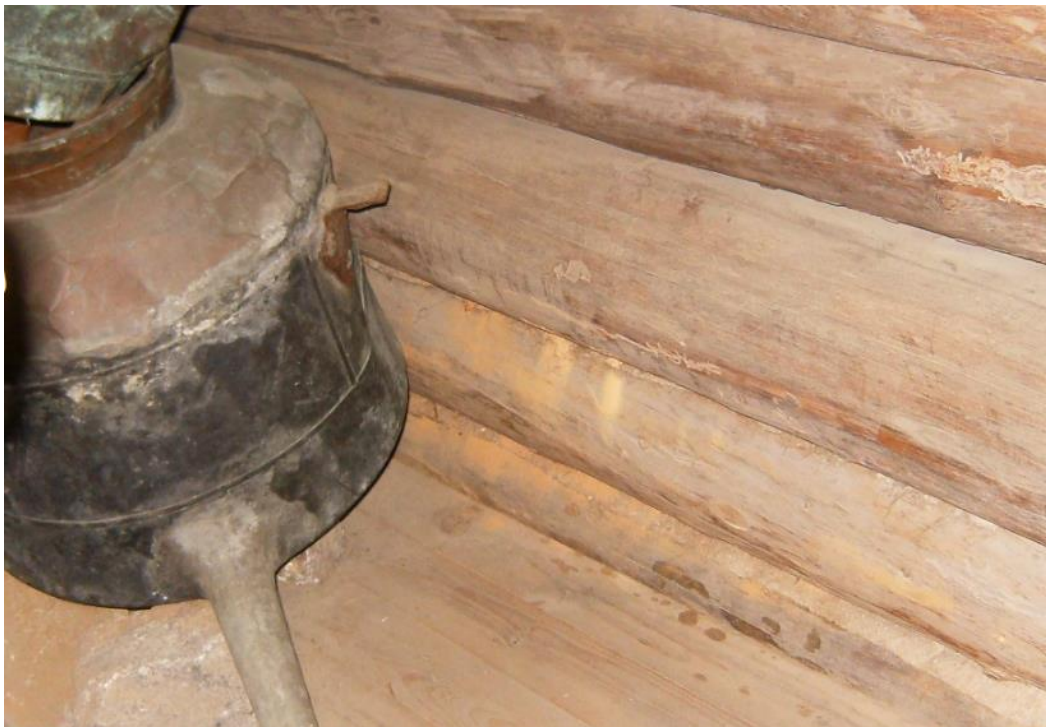
Kuva 20 Keuruun kotiseutumuseon päärakennuksen vintillä hirsien välistä tulee purua, mikä viittaa hyönteisvaurioon.
