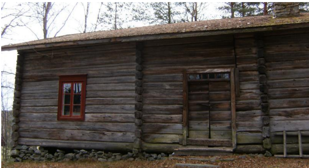
Kuva 14 Jämsän Pälämäen kotiseutumuseon päärakennus, Lepolan pirtti 1790-luvulta. Rakennuksen pärekatto odottaa uusimista.
