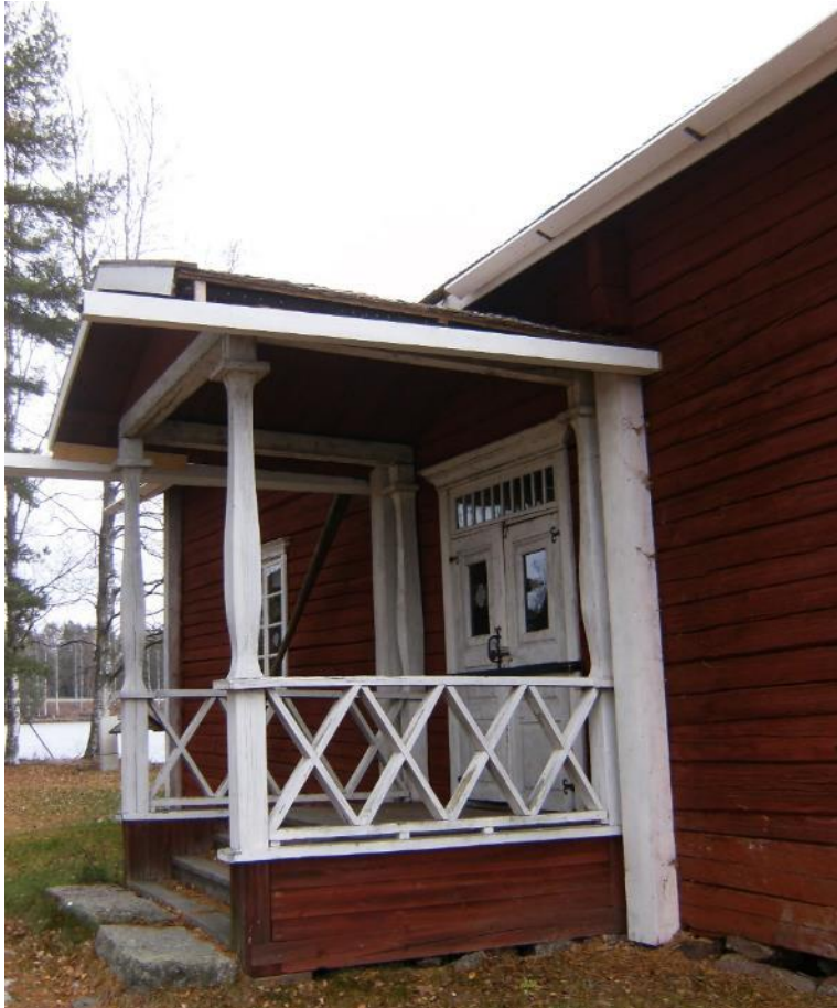
Kuva 17 Jämsänkosken Aarresaaren kotiseutumuseon päärakennus, Kosken rustholli vuodelta 1840. Rakennuksen runko painuu enemmän kuin kuisti, joten kuisti on vinoon rakennukseen päin. Puiset sadevesikourut ovat asennettu johtamaan sadevesi pois päin rakennuksesta.
