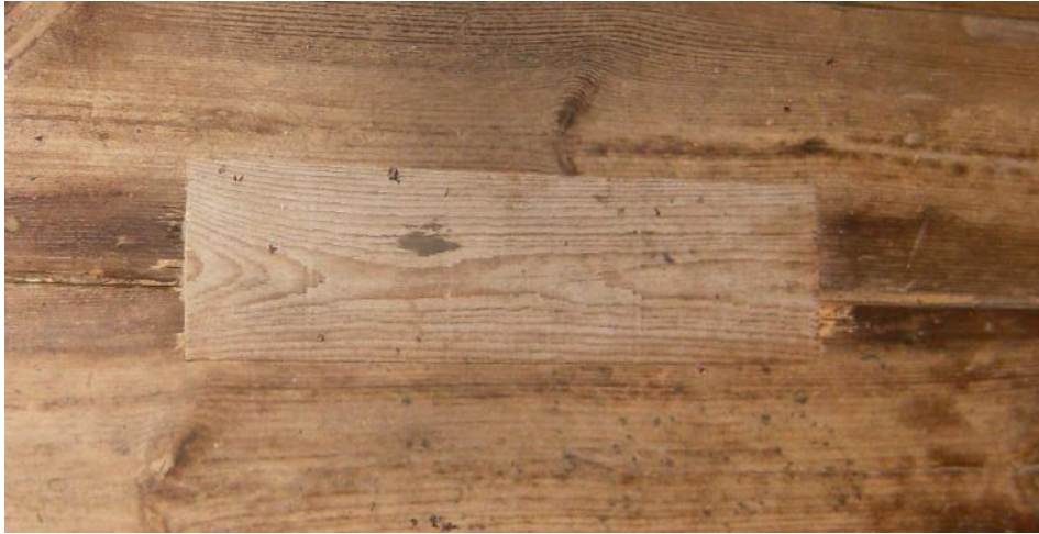
Kuva 25 Kuoreveden kotiseutumuseon kellotornin liitos on vuotanut ja lahottanut vintin lattiaa. Kohtaan on tehty huomaamaton paikka, eikä ole turhaan vaihdettu koko lattialautaa.
