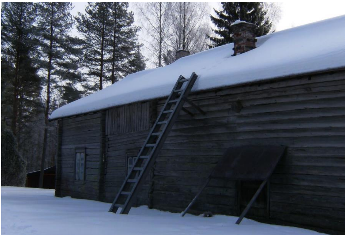
Kuva 15 Joutsan talomuseon päärakennus, Mesiäisen talo 1700-luvulta (laajennus 1800-luvulta). Rakennuksen seinässä kasvaa paikoin vihreää leväkasvustoa.
