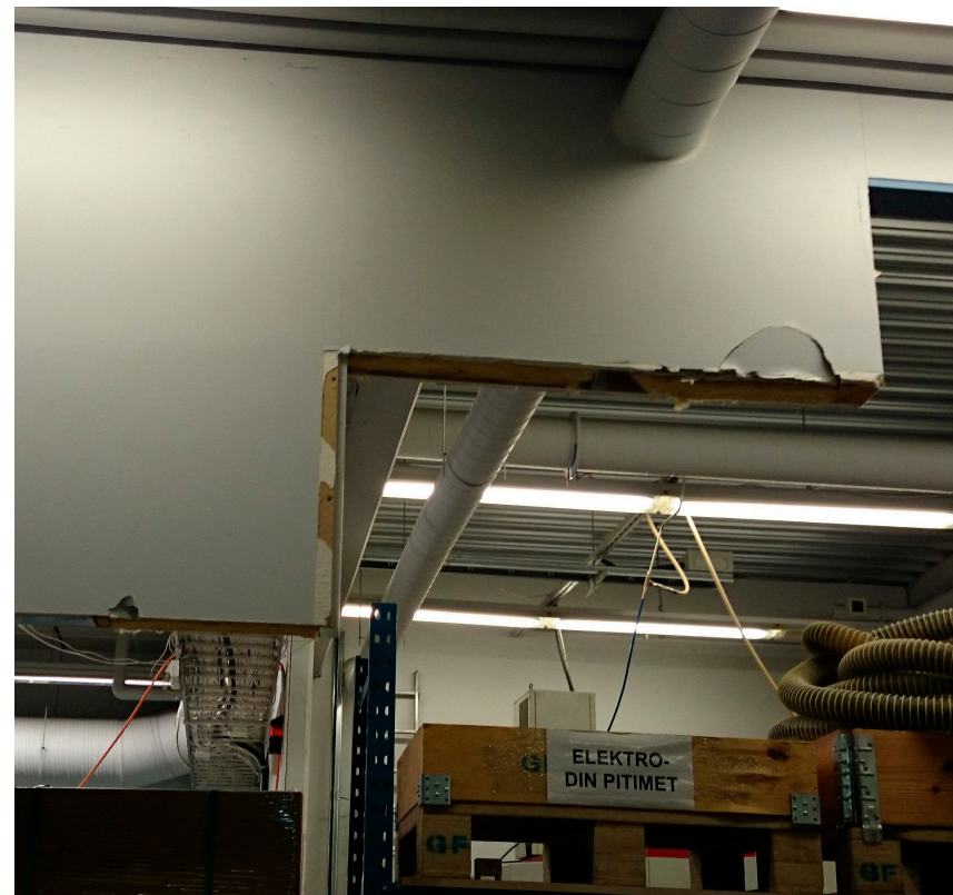
Kuva 11. Epäkohtia Greenfoxin tiloissa: ruhjeita seinässä, kulahtanut paperilappu laatikon kyljessä ja hämärä valaistus.
