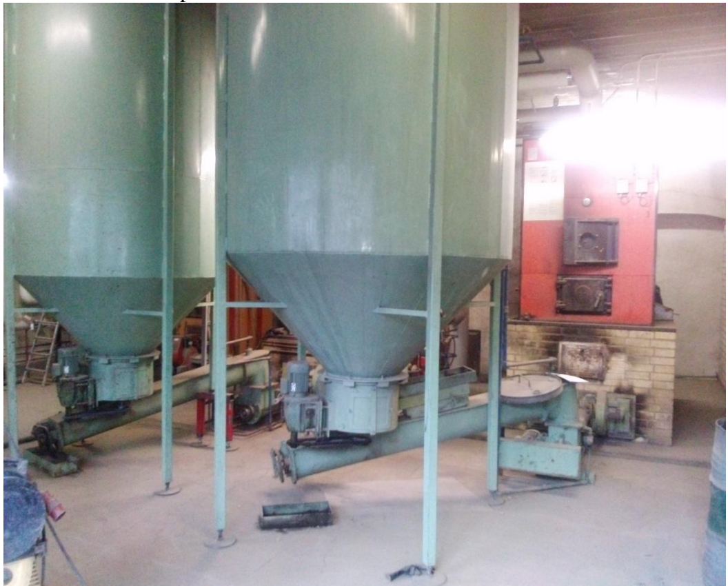
Kuva 1. Pannuhuone ja oikealla kuvassa uusittava hakepannu
