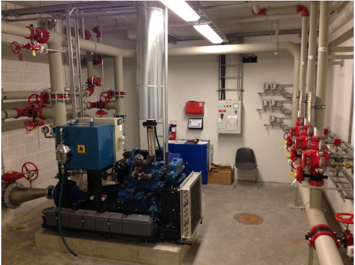
Kuva 7. Hotelli Levi Panoraman sprinklerijärjestelmä
