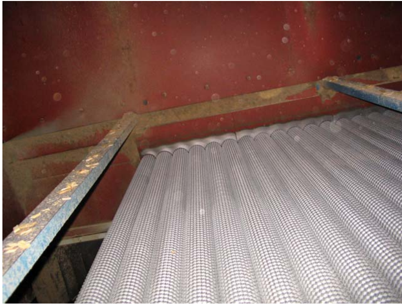
Kuva 8. PocketRoll-puruseula. Paksuusseulan läpäissyt jae putoaa puruseulalle ja puruseulan ylite kulkeutuu keittoon menevälle kuljettimelle.
