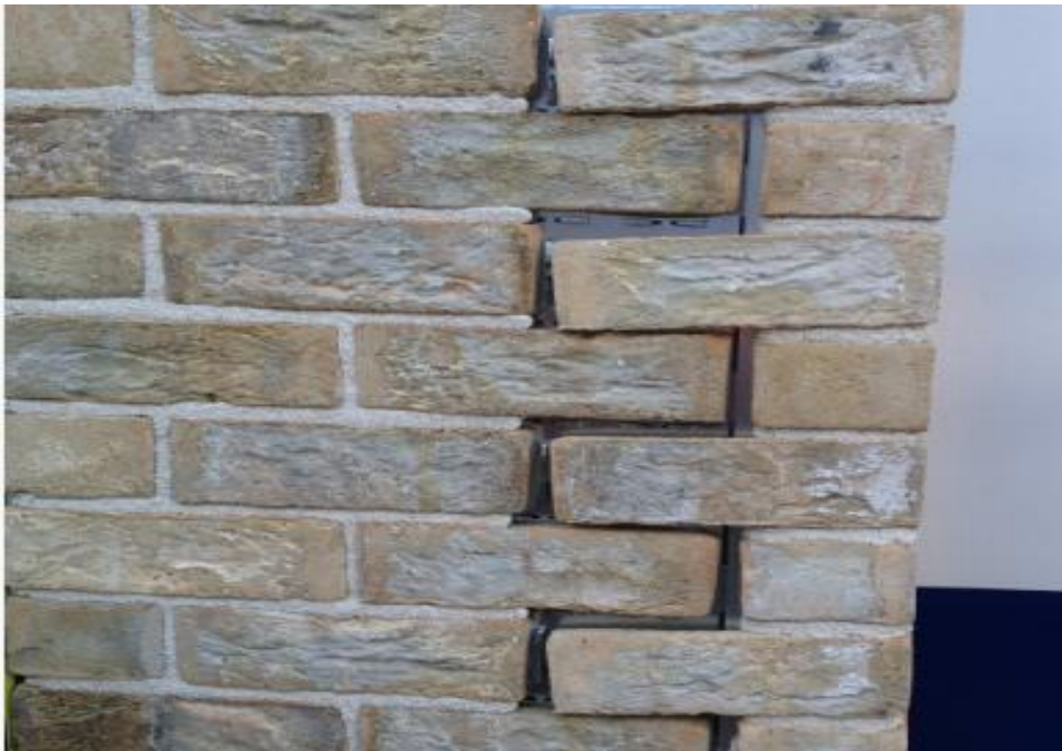
KUVA 5. Esimerkki testiseinästä, jonka kulmatiilissä on liian suuria mittapoikkeamia
