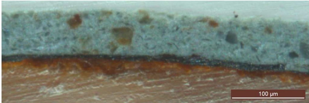
Kuva 34. Näyte VN2-10: maalikerrokset uudemman huoltoluukun päältä 24.11.2010. Alinna oleva punainen on raudan korroosiota, hopeanvärinen on pohja/ruostesuojamaali ja vaaleanharmaa on viimeinen ja ainoa pintamaalikerros. Ylimmän kerroksen punaiset pilkut ovat saattaneet siirtyä poikkileikkäusnäytettä hiottaessa alapuolisesta ruostekerroksesta, joka on hyvin löyhärakenteinen.
