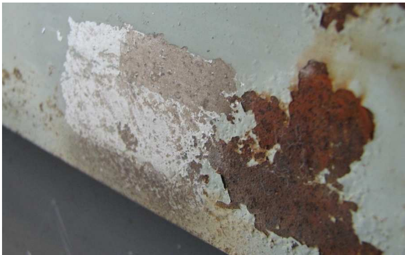
Kuva 66. VN2:n uudemman huoltoluukun maalikerroksia 26.10.2010.
