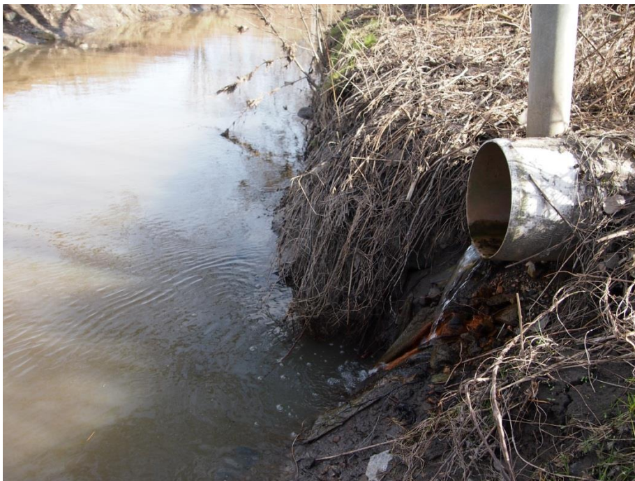
Kuva 18. Iso-Heikkilän teollisuusalueen hulevesiviemäri.
