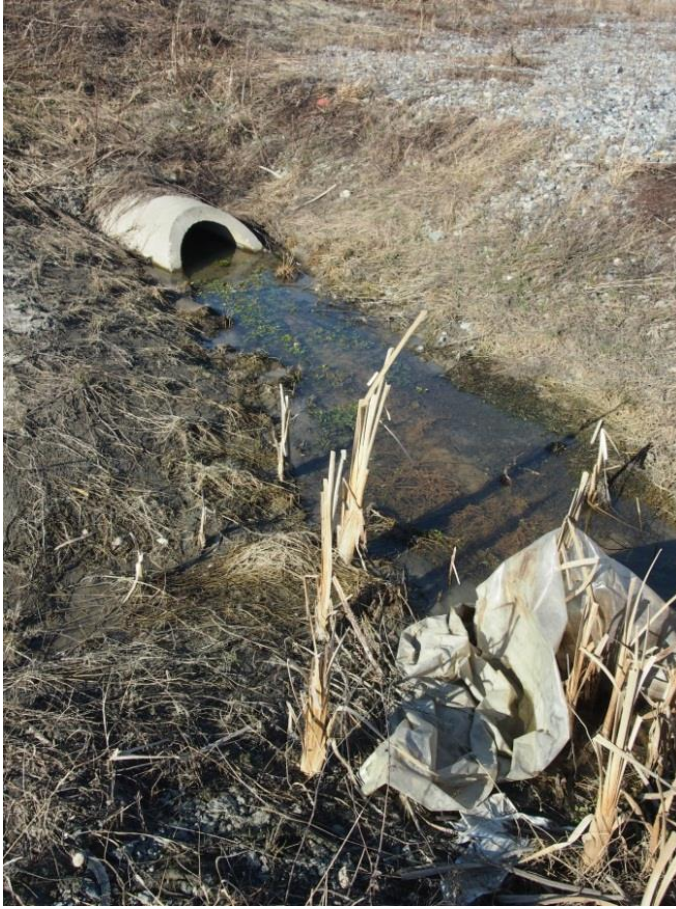
Kuva 12. Hulevesiviemäri Kuninkojan asuinalueella.
