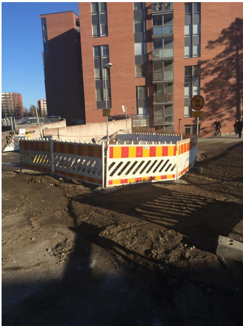
Kuva 1. Suojattukaivanto (Toni Räsänen 2015)
