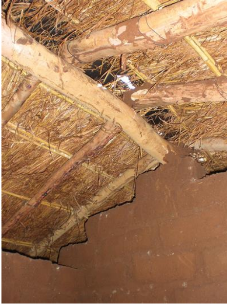
Kuva 10: Vanhuksen talon rikkiäinen katto.
