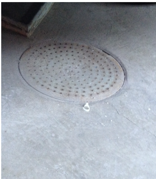
Kalustohallin hiekan- ja öljynerotuskaivo
