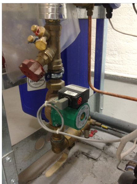
Lämpimän käyttöveden kiertovesipumppu
