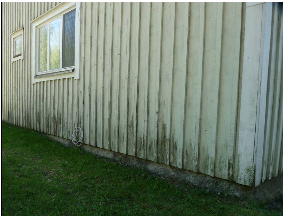
Kuvio 9: Rakennuksen pohjoispääty on sammaloitunut
