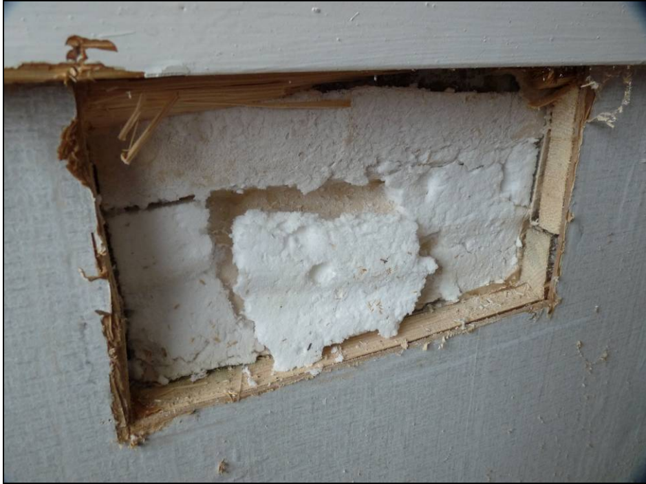
Kuvio 2: Rakenteeseen ruiskutettua ureaformaldehydivaahtoa
