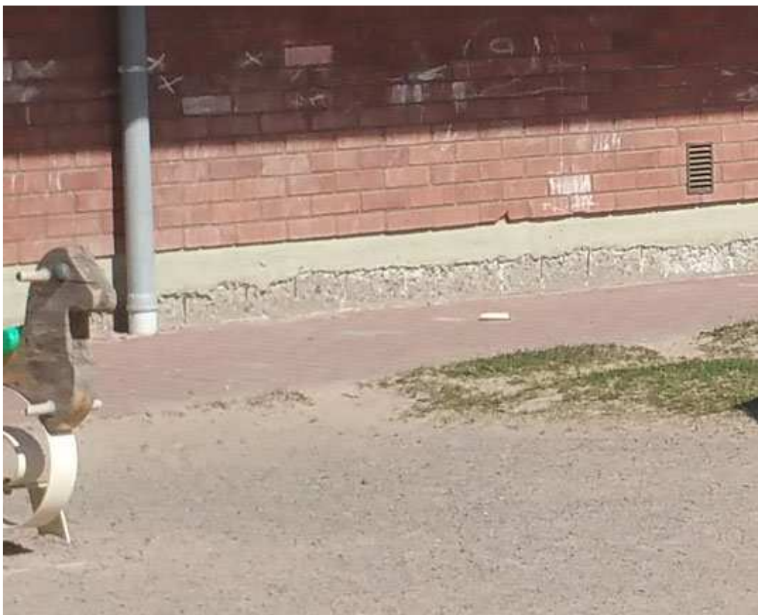
Kuva 10. Vaurioita päiväkodin sokkelissa
