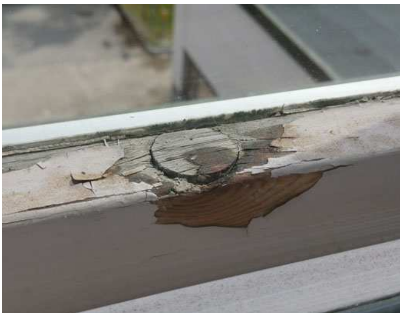
Kuva 1. Kosteusjälkiä ikkunan ulommaisessa puitteessa
