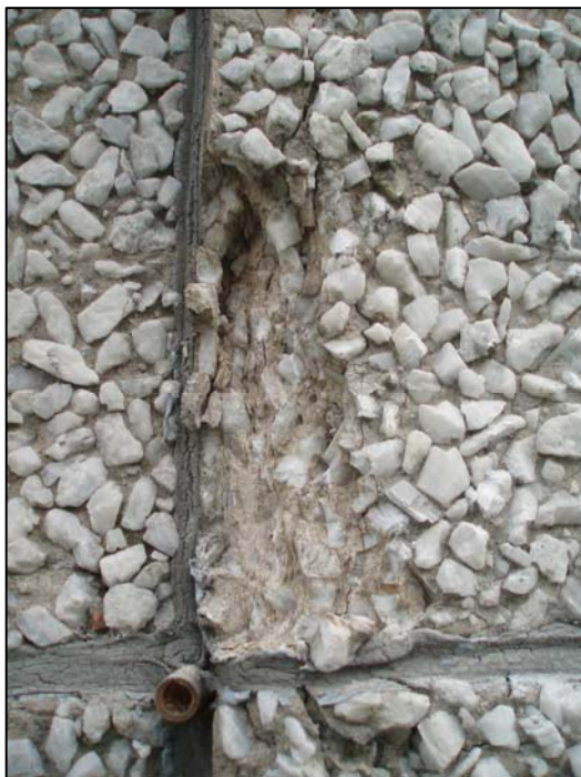
Kuvio 1: Rapautunutta pesubetonia
