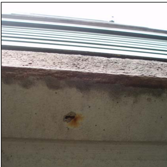
Kuva 14 Ruostunut teräs laatan alapinnassa
