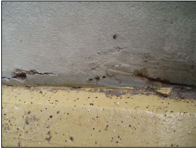
Kuva 16 Pielen alaosan korroosiovaurioita
