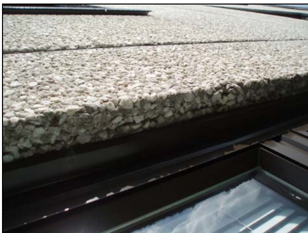
Kuva 3 Ikkunan pielen halkeilua
