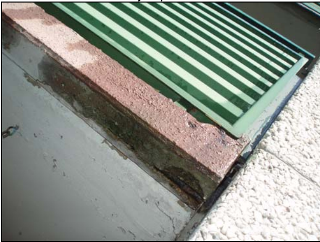
Kuva 12 Vaurioitunut parvekekaton reuna
