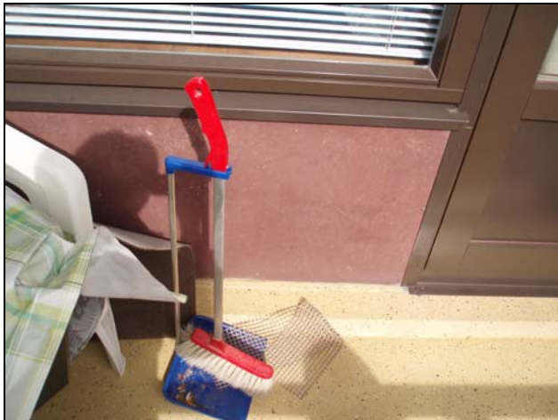
Kuva 8 Huoneistoparvekkeen taustaseinän vaneri
