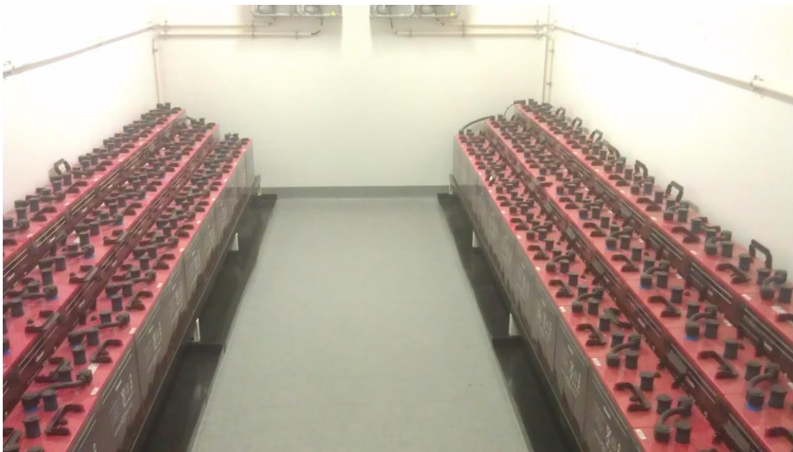
Kuva 4. Kahdenntetun tasasähköjärjestelmän kaksi akustoa (Tähtinen 2015.)
