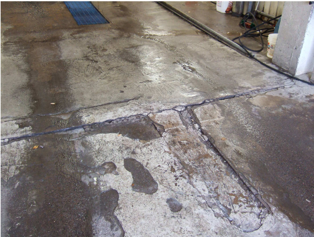
Kuva 3. Rakennevauriokuva hallin lattiasta (Porin toimipiste)
