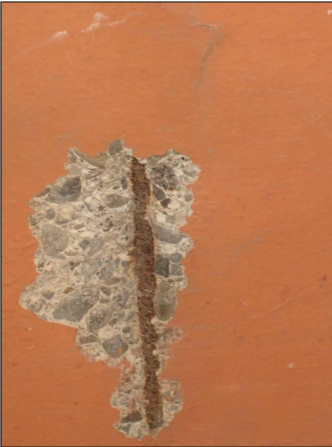
Kuva 5 Teräskorroosioaurio parvekekaiteen sisäpinnassa
