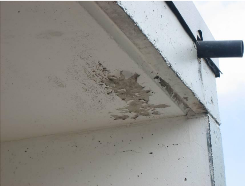
Kuva 1 Kosteusvaurio parvekelaatan alapinnassa
