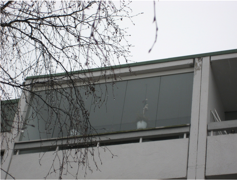
Pielen ja katteen välinen vuotovaurio
