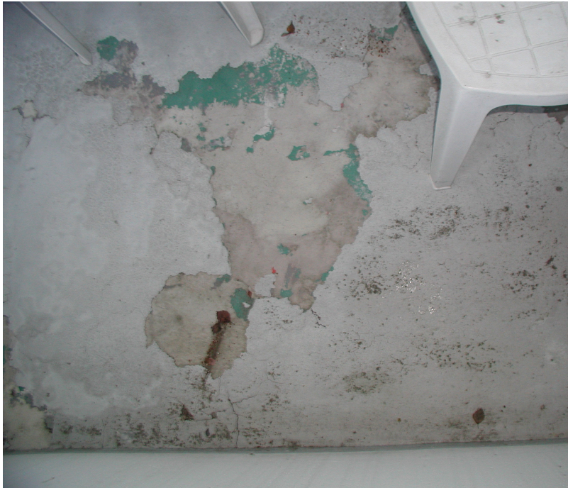
Kuva 7 Parvekelaatan irronneet pinnoitteet
