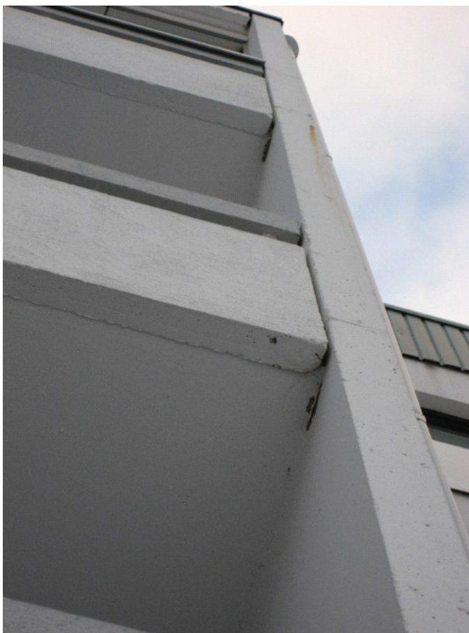
Kuva 10 Pielen toistuva vaurio ja ruostejälkiä
