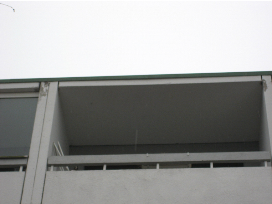
Toistuva pielen ja katteen vaurio
