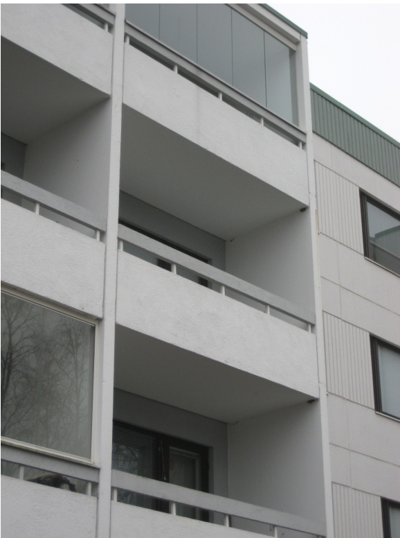
Toistuva vaurio piellelementissä
