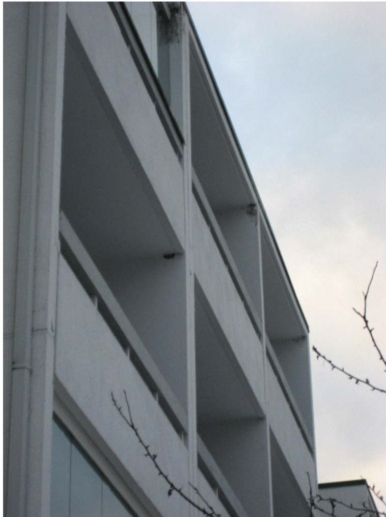
Kuva 11 Pielien vauriot vuotavasta saumasta
