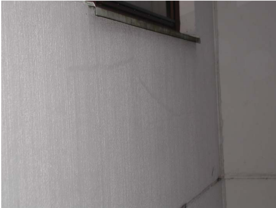
Kuva 2 Elementin halkeilua ikkunan alla.
