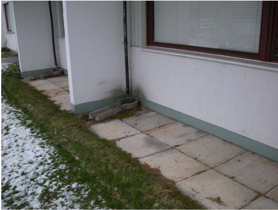
Kuva 12 Parvekkeiden vedenpoistoputken alareuna.
