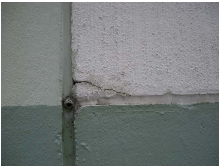
Kuva 3 Betonin halkeilua elementin reunoilla.
