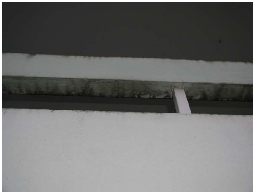
Kuva 7 Voimakkaan säärasituksen alainen parvekekaide.
