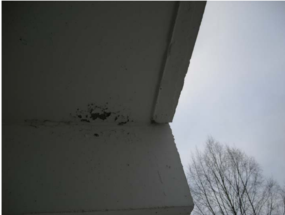
Kuva 10 Parvekelaatan ja pielitelementin maalin hilseilyä.
