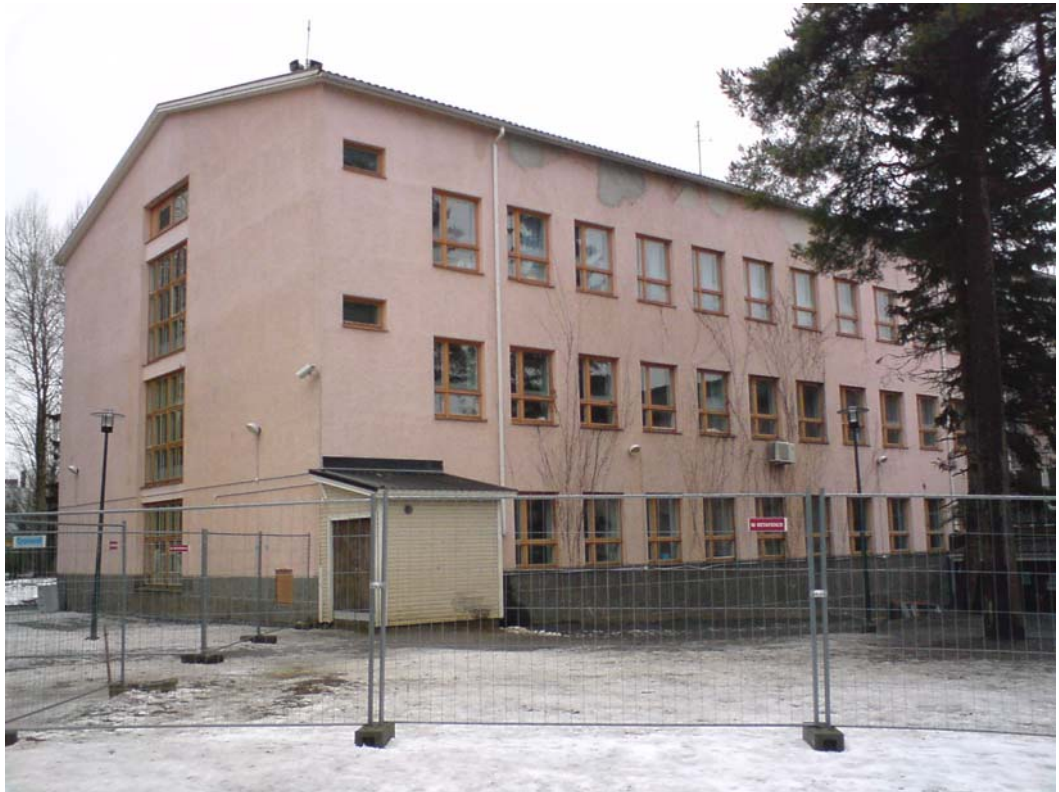
Kuva 5 C-osan pohjoispää, kuvassa näkyy julkisivun vanhoja rappauspaikkauksia seinän yläreunassa
