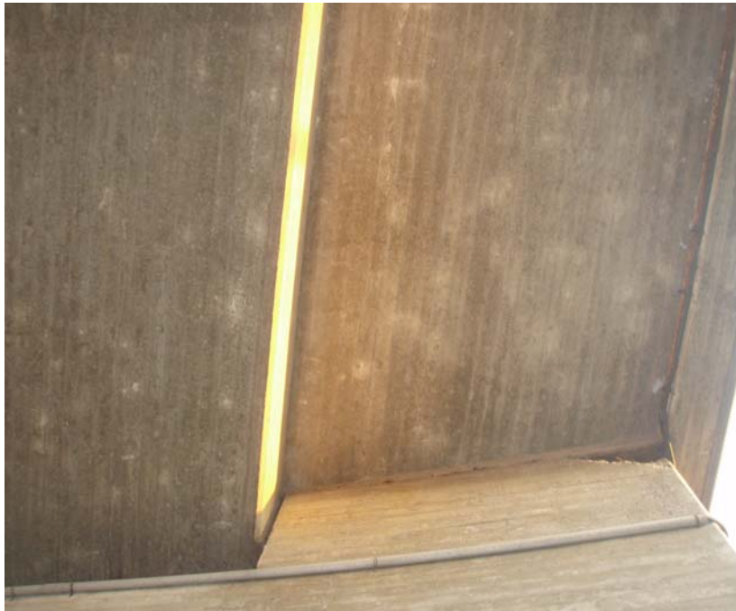
Kuva 22 Valokuva kansilaatan reunasta ja reunaulokkeesta sillan lounaiskulmassa
