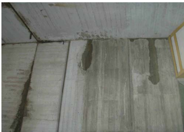
Kuva 35 Valokuva vuodoista, jossa erottuvat märät kohdat
