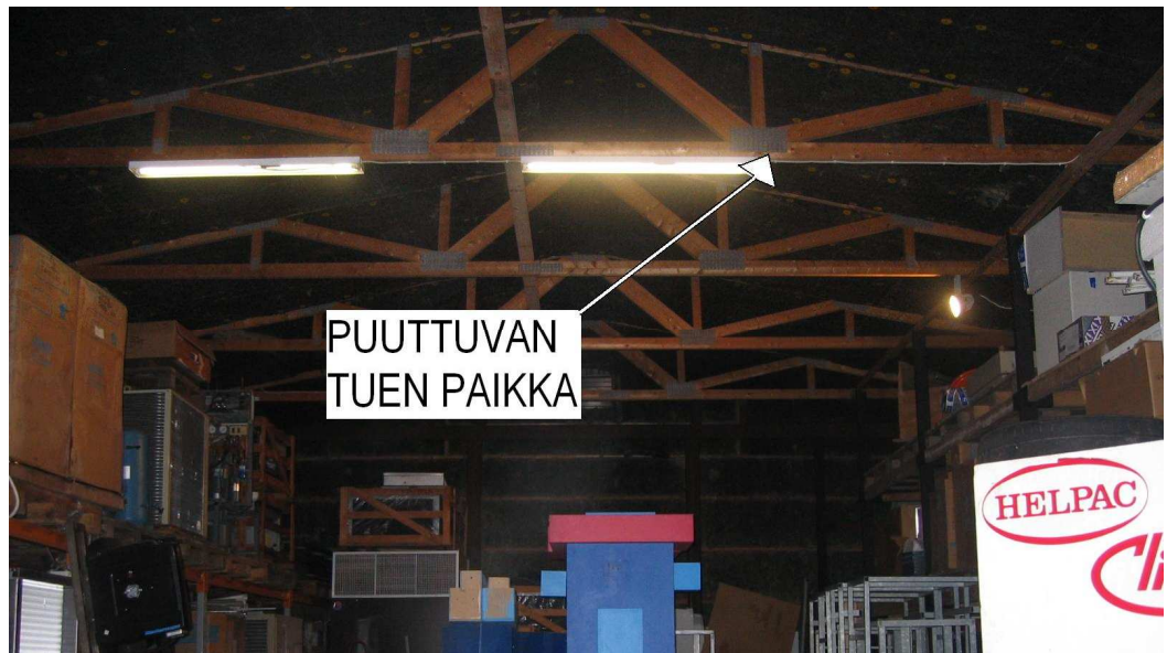
Kuva 3 Alkuperäiset kattotuolit ja puuttuvan tuen paikka.
