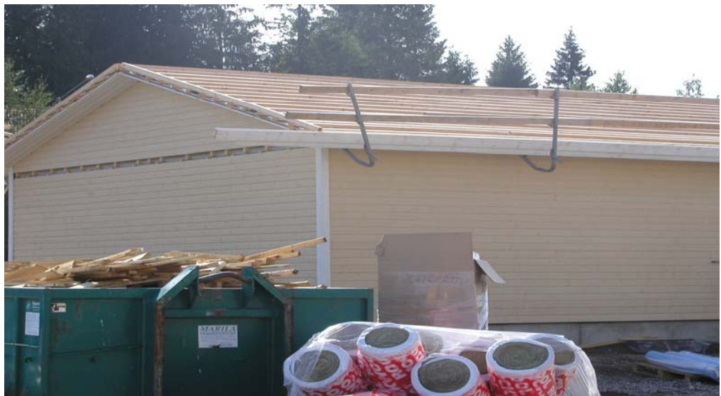
Kuva 6 Päätyräystään suojakaiteet puuttuvat /4/
