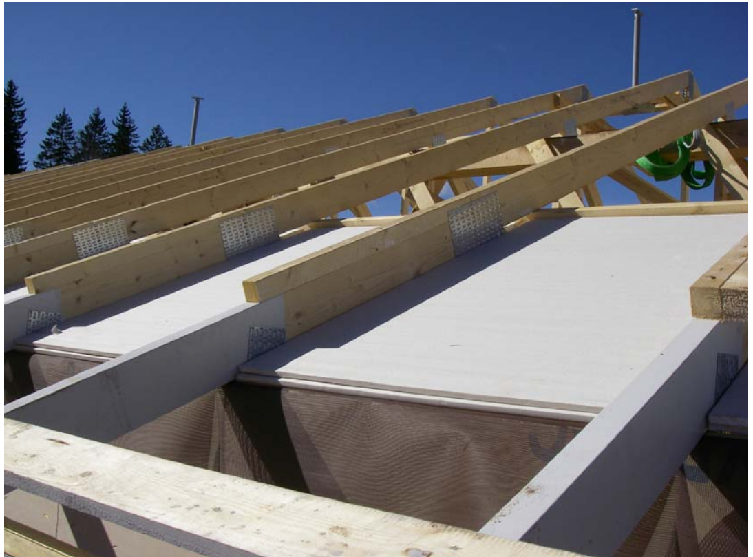
Kuva 13. Kattopollarit, joiden väliin asennetaan tarrainta varten vaijeri /4/
