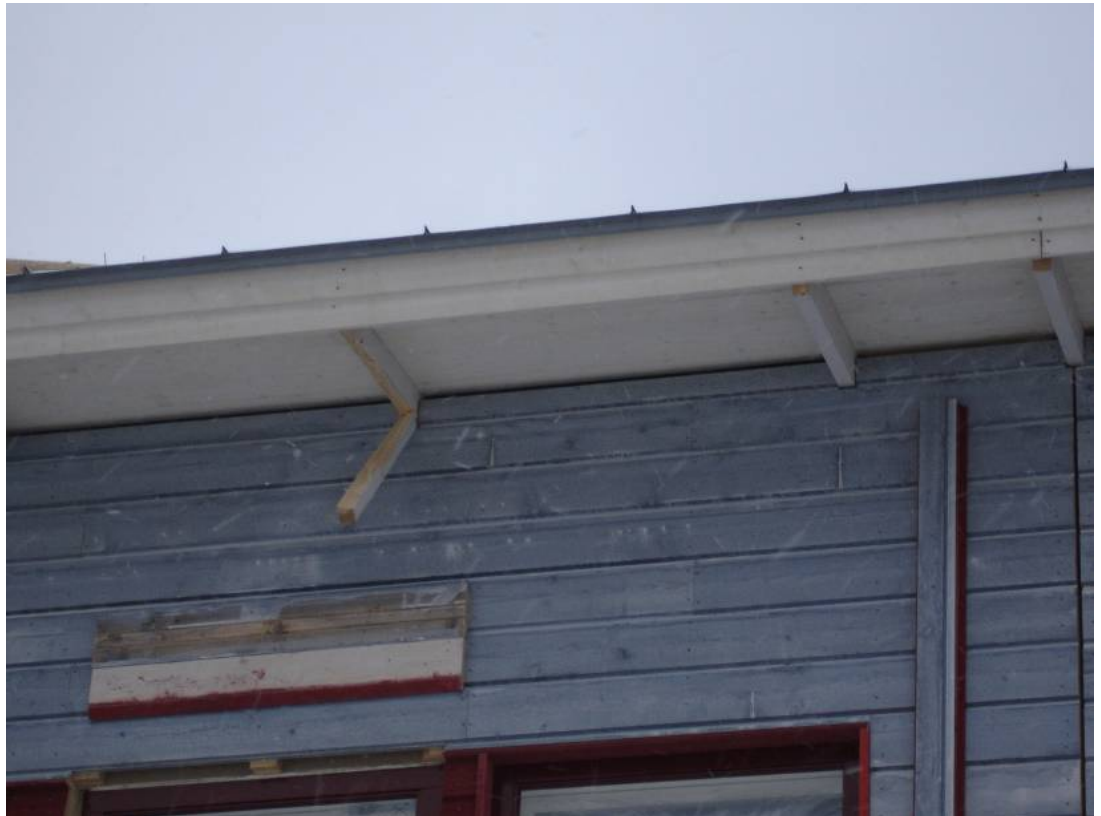
Kuva 9. Kattokannattajan pää haljennut, kun tuuli on pudottanut kaiteet alas. /4/
