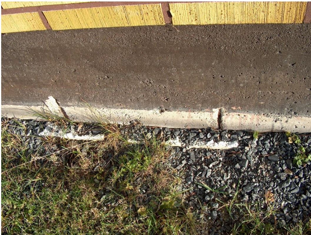
Sokkelin nurmettuunut sepelikaistale ja esillä oleva routaeriste
