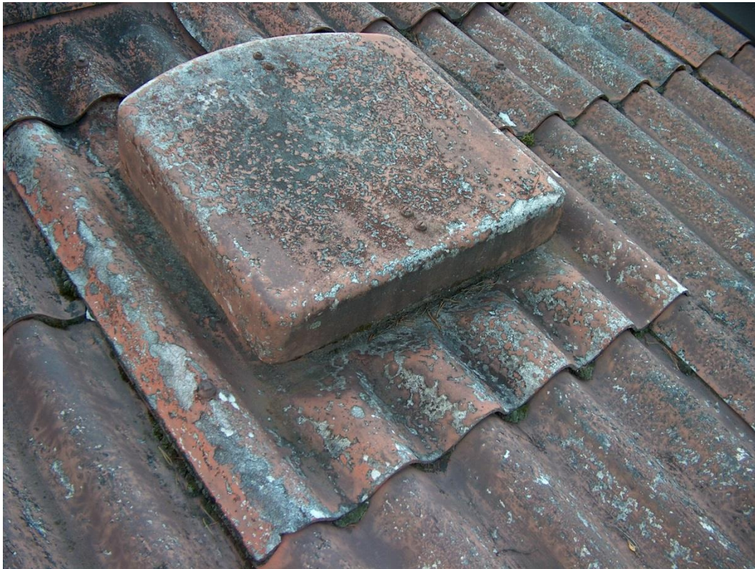
Vesikaton kattoluukku ja katteen hilseillyt maalipinta
