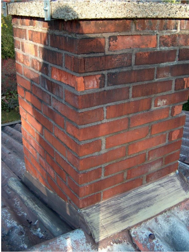
KUVA 8. Savupiipun tiilissä havaittavissa pakkasrapaumaa
