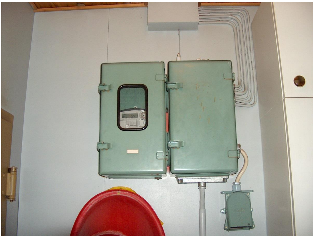
Sulake- ja sähkömittarikaapit
