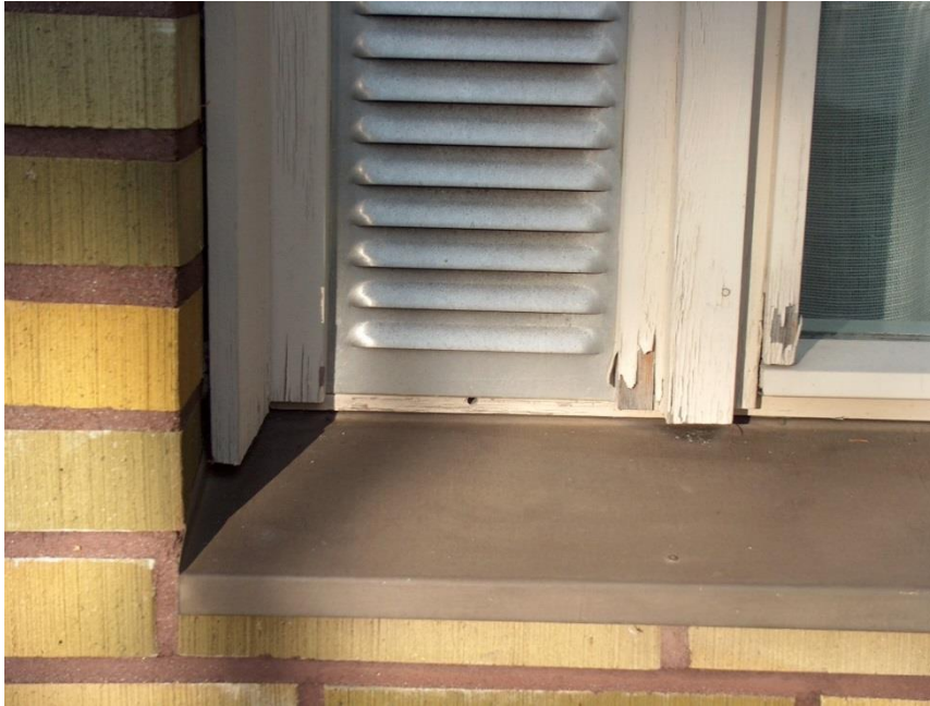
KUVA 4. Ikkunan puitteiden huonokuntoinen ja lohkeillut maalipinta
