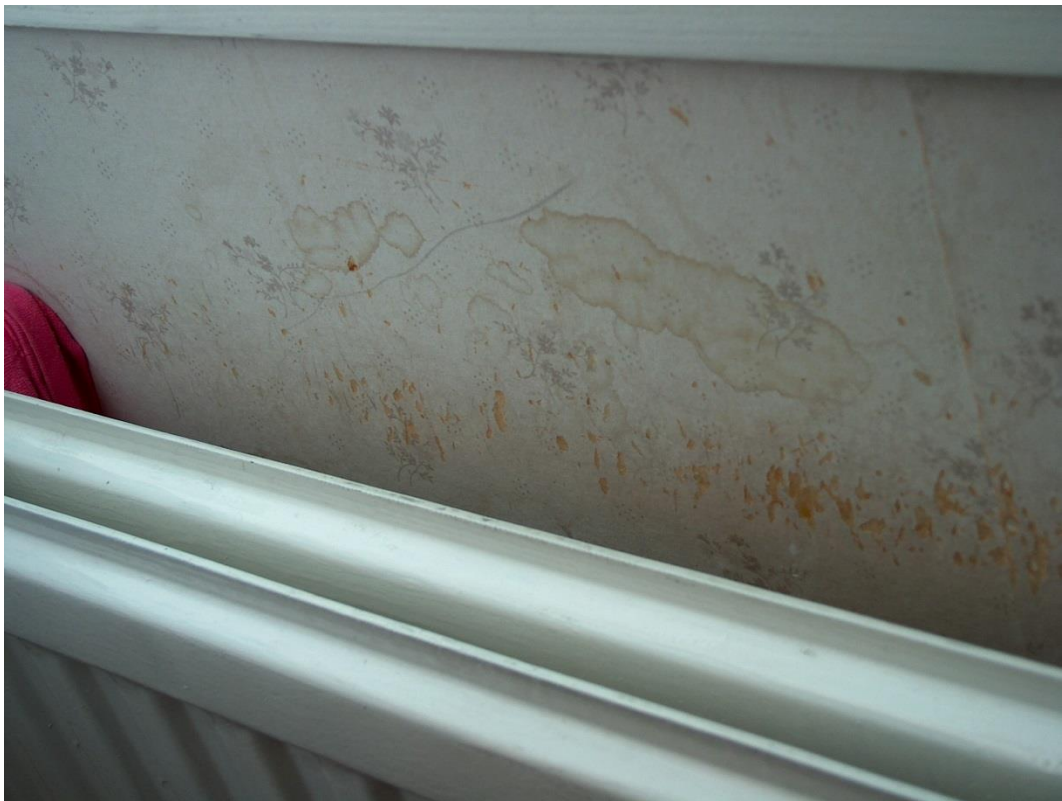
Päämakuuhuoneen patteriseinällä näkyvät kosteusjäljet
