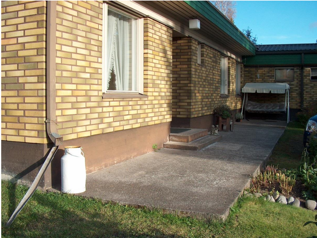
Etupihan betonilaatat, liian lyhyt syöksytorvi ja rännikaivojen puuttuminen
