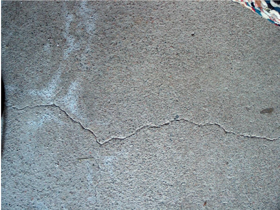
Halkeama autotallin betonilattiassa
