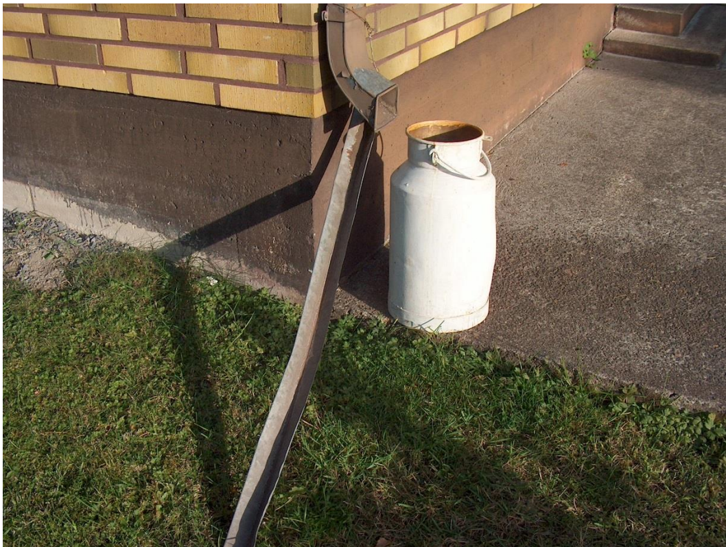
Syksytorvien hilseillyt maalipinta ja puutteellinen sadevesien ohjaaminen
