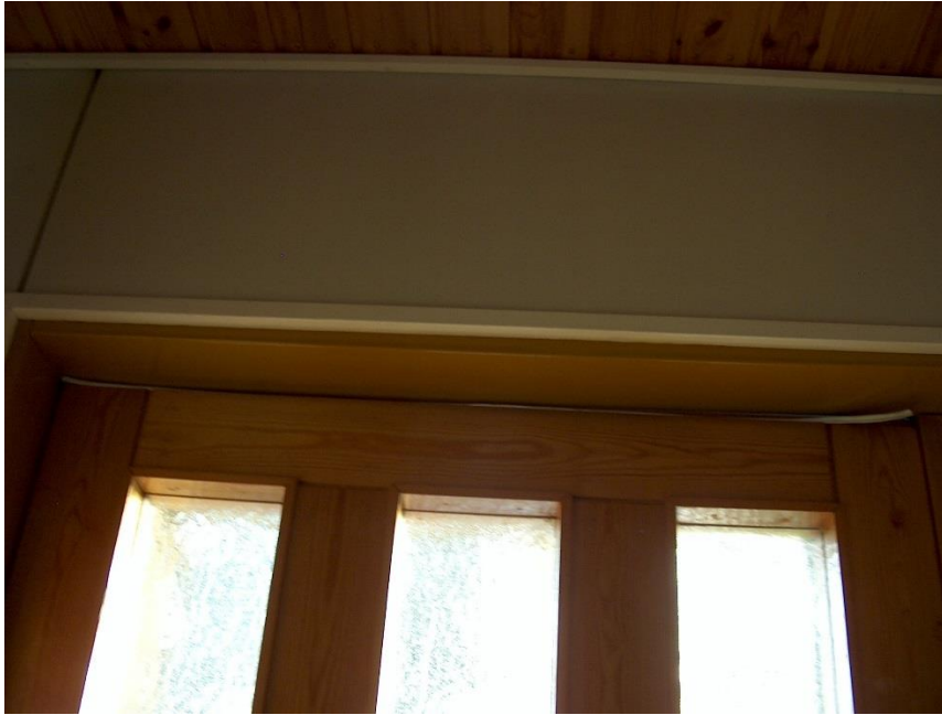
KUVA 5. Ulko-oven puutteellinen tiiviste
