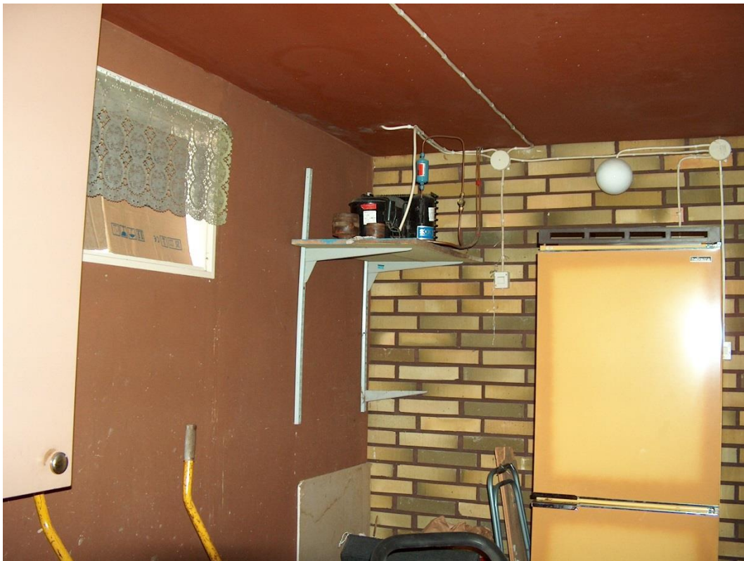
Kylmlaitteiston kompressori autotallissa
