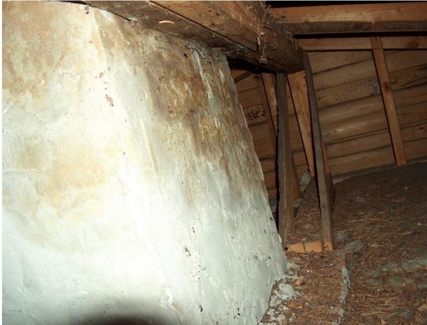
KUVA 6. Savupiipun puutteellisesti tiivistetyn läpiviennin vanha kosteusvaurio
