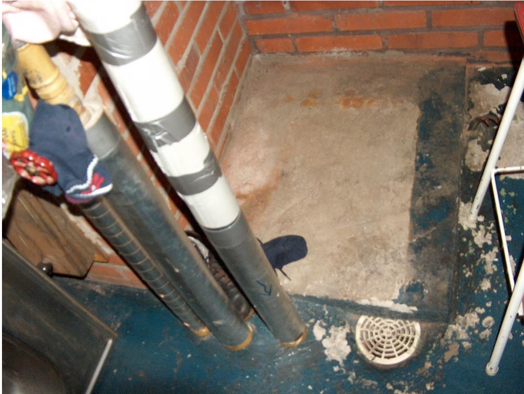
Kattilahuoneen betonilattian hilseillyt maalipinta ja viemärikaivo
