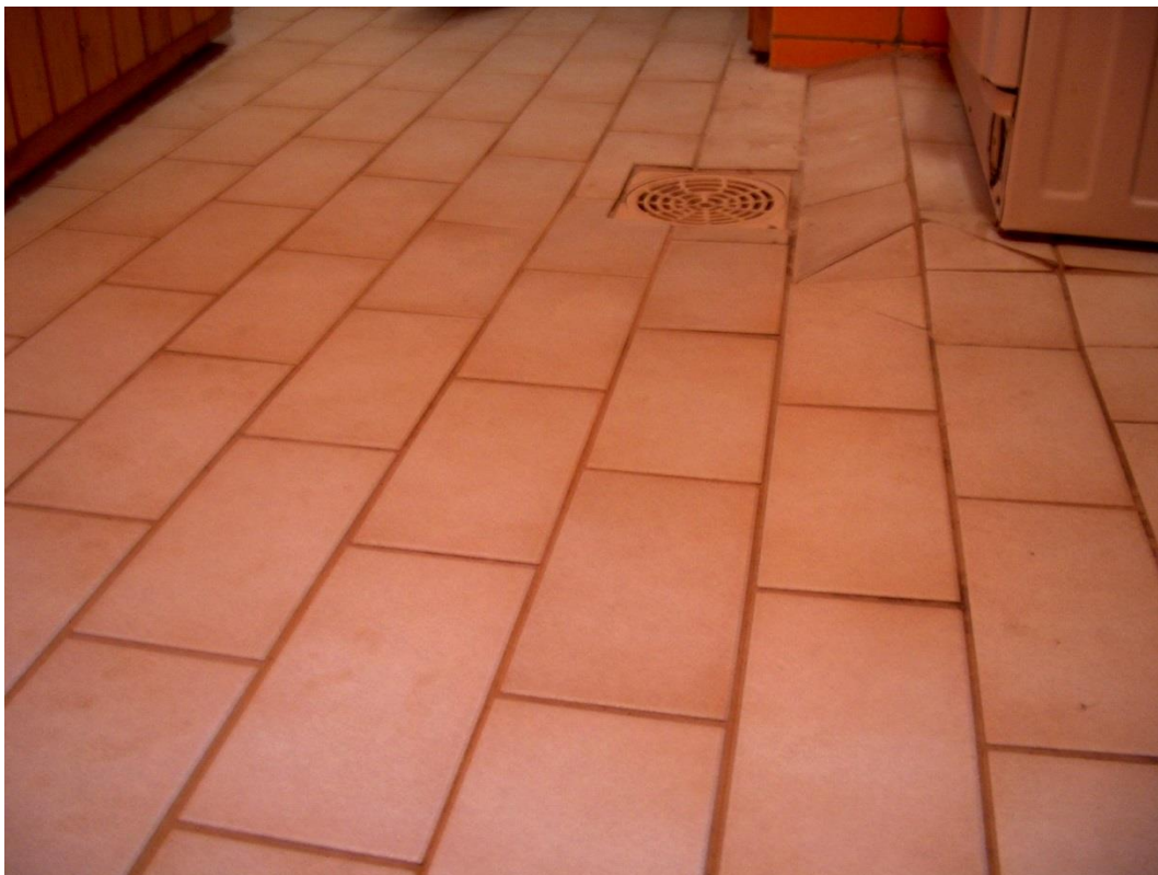
Pesuhuoneen lattian kallistukset
