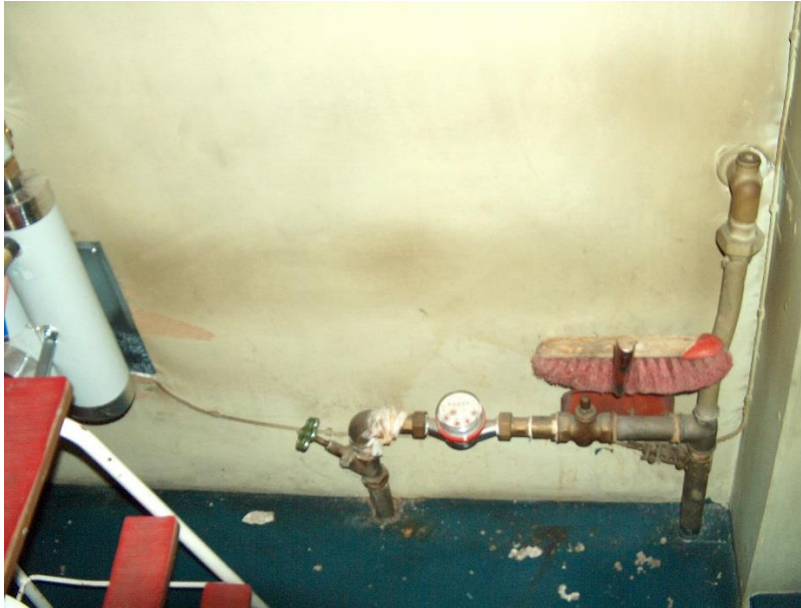
KUVA 7. Kattilahuoneen seinä ja lattia kohonneiden kosteusarvojen alueelta
