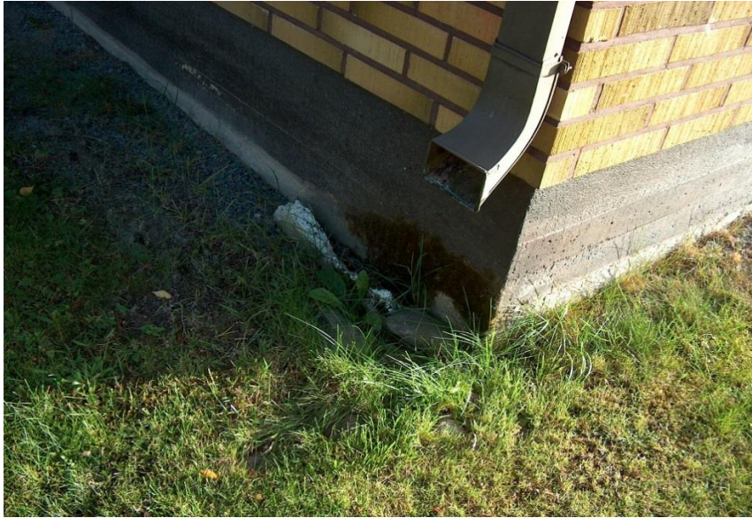
KUVA 2. Koillispuolen sammaloitunut sokkeli syökytorven alapuolella
