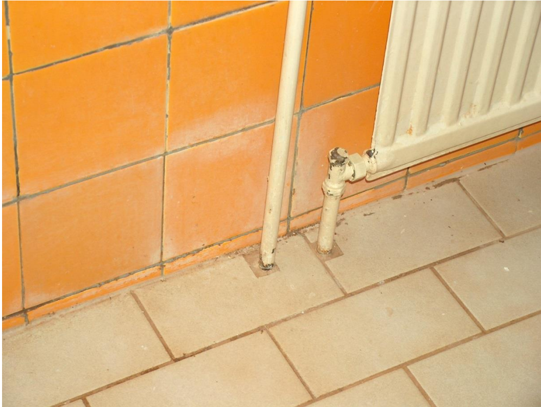
Pesuhuoneen seinän haalistuneet laatat
