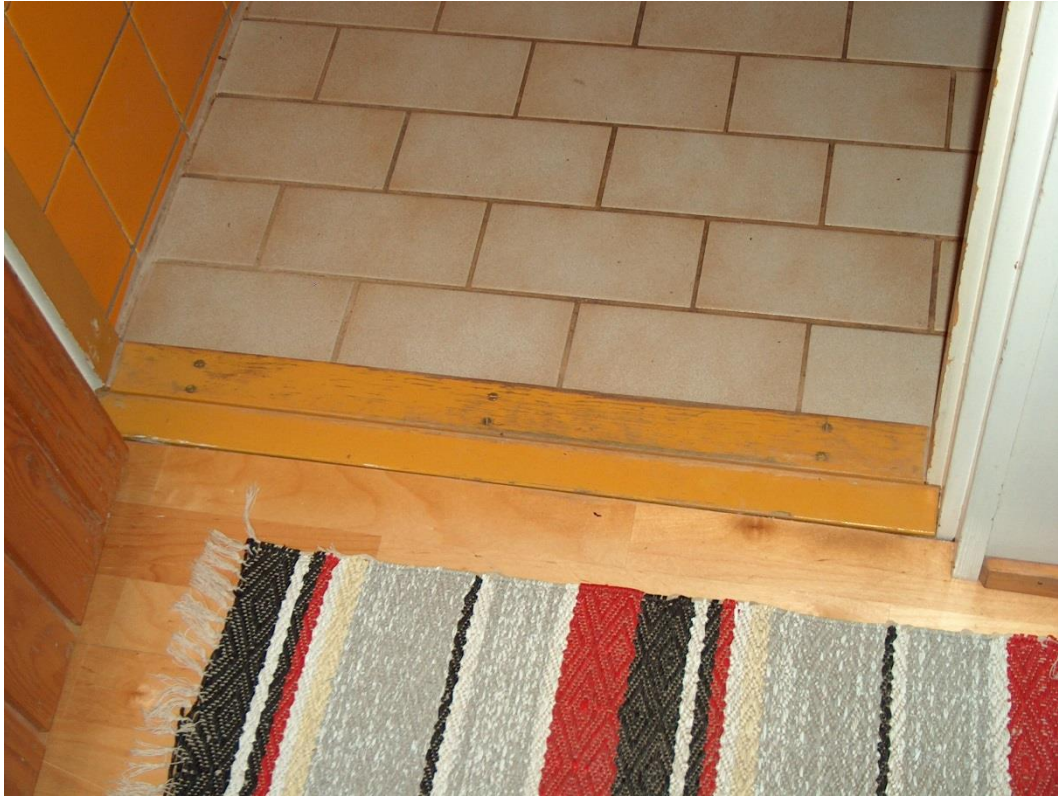
Pesuhuoneen oven ja kynnyksen kuluneet pinnat
