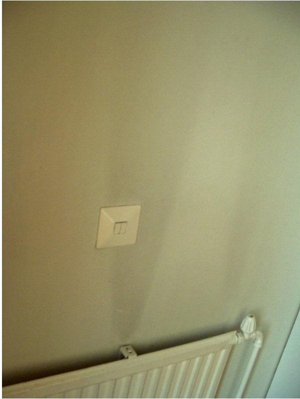
Tuulikaapin patteriseinällä näkyvät tummentumat
