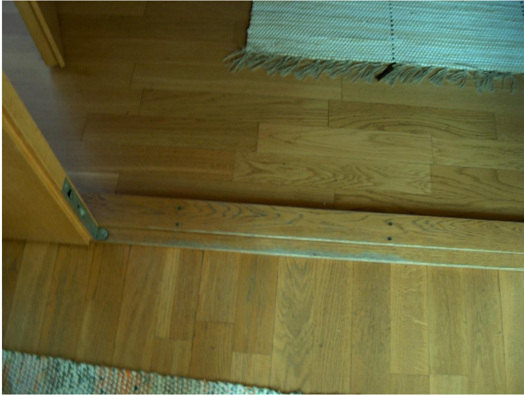
Tuulikaapin ja eteisen kulunut lattianpinta ja kynnys
