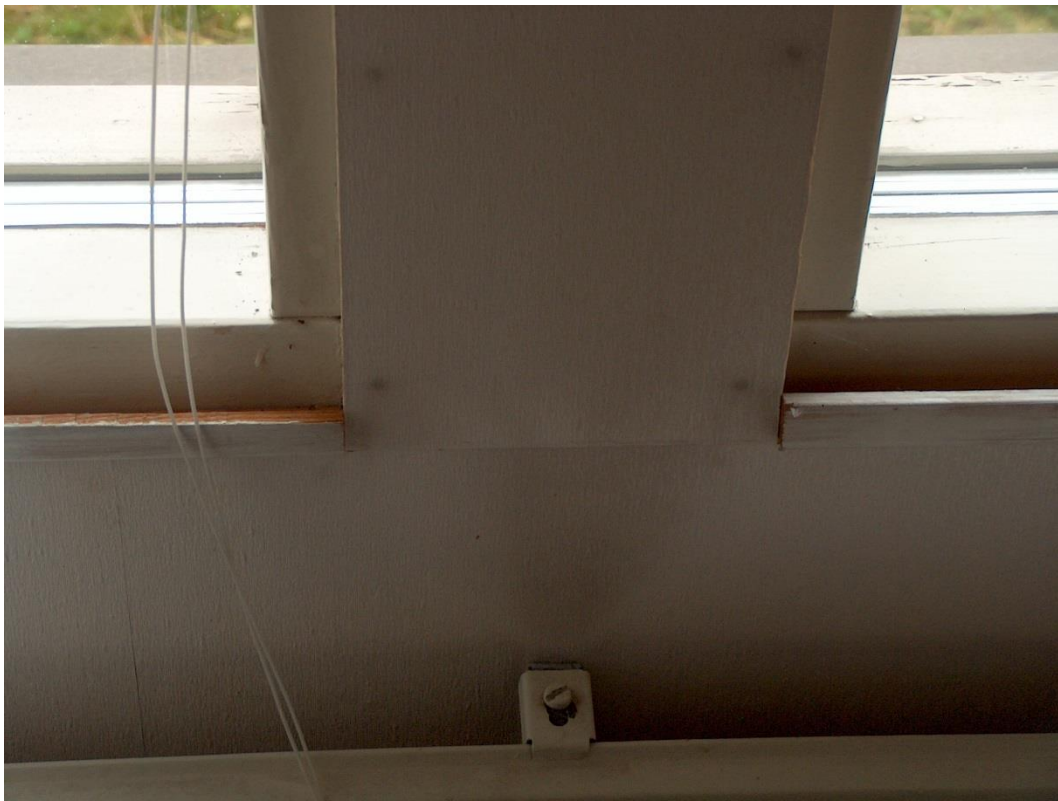
Olohuoneen ikkunoiden sisäpuitteiden huono maalipinta
