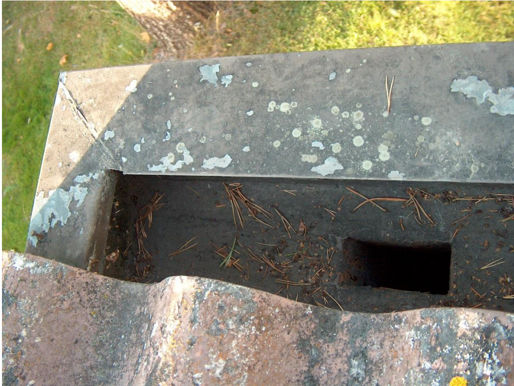
Vesikourujen hilseillyt maalipinta
