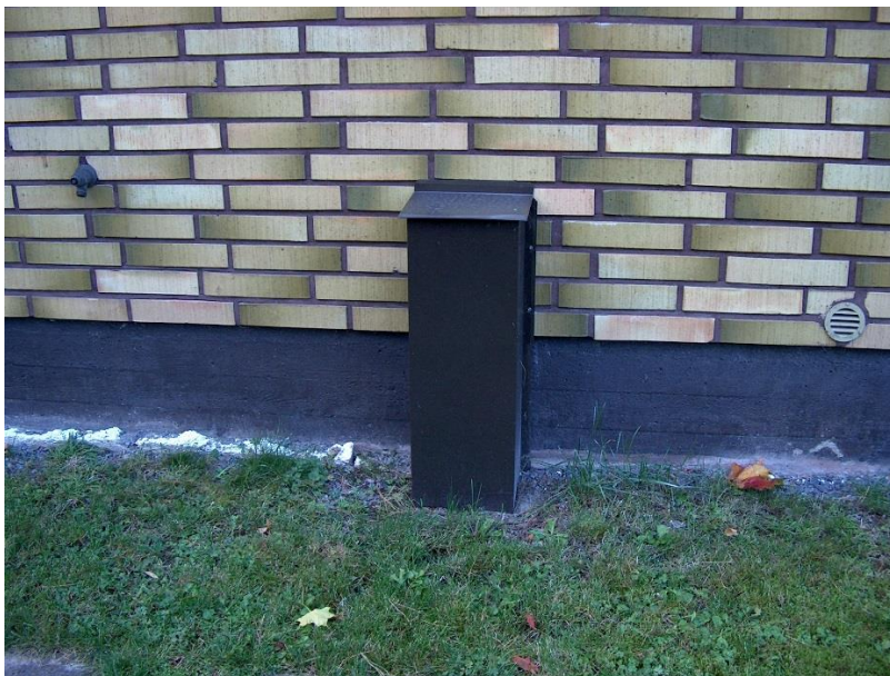
KUVA 8. Kattilahuoneen ulkoseinä kohonneiden kosteusarvojen kohdalta
