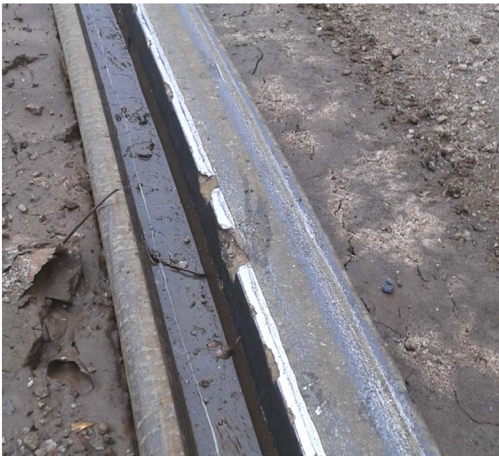
Kuva 14. Kulunut ja reunastaan lohkeillut urakisko pienen kaarresäteen alueella.
