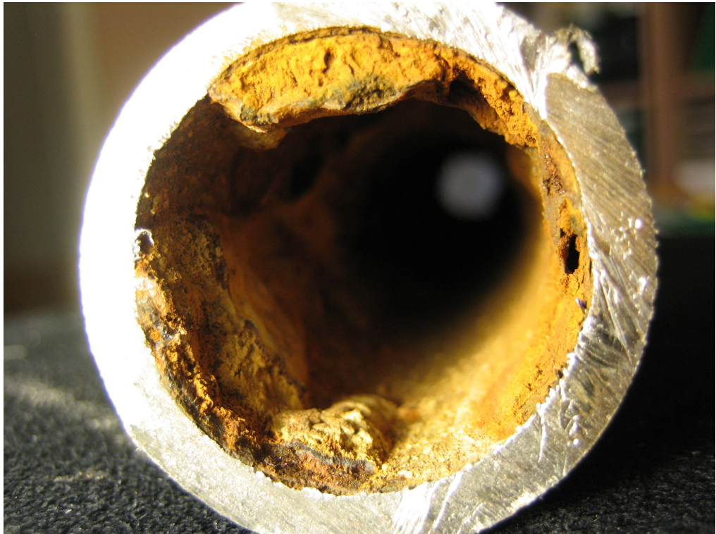
Kuva 8 Ruostetta kylmänveden nousuputkessa, putki vuodelta 1950 (seinämän vahvuus n. 4 mm)
