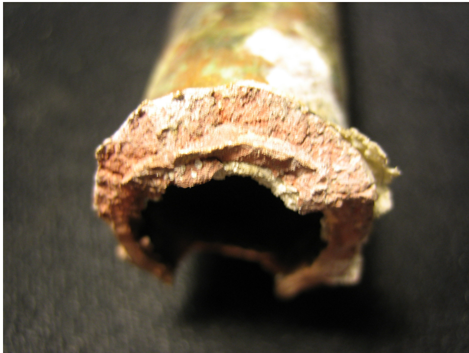
Kuva 6 Sinkkikato messinkijuotoksessa, jäljellä huokoinen kuparirakenne, putki vuodelta 1950
