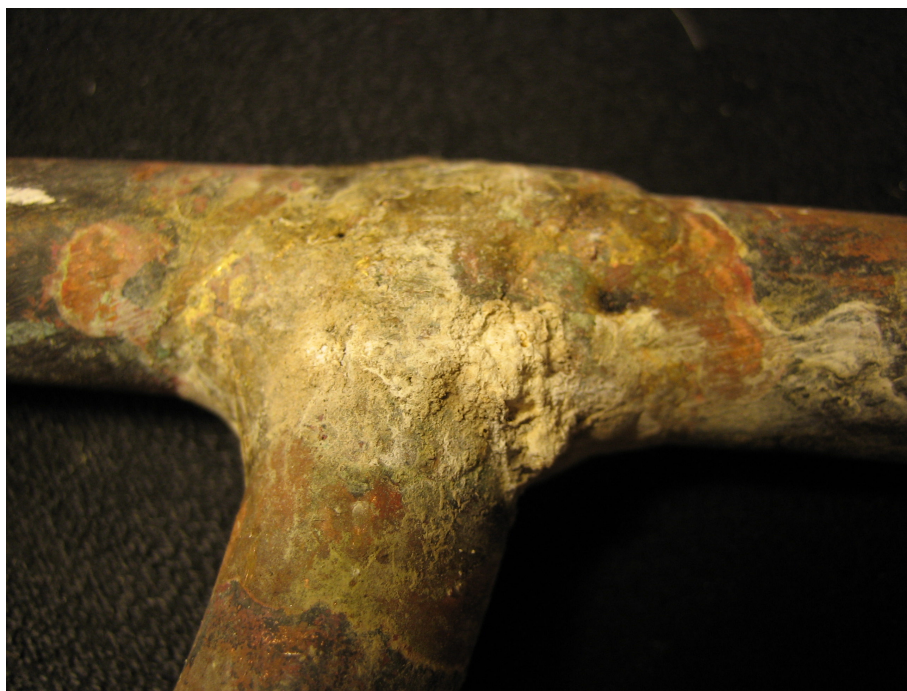
Kuva 5 Sinkkikadon merkkejä kuumavesiputkessa, putki vuodelta 1950
