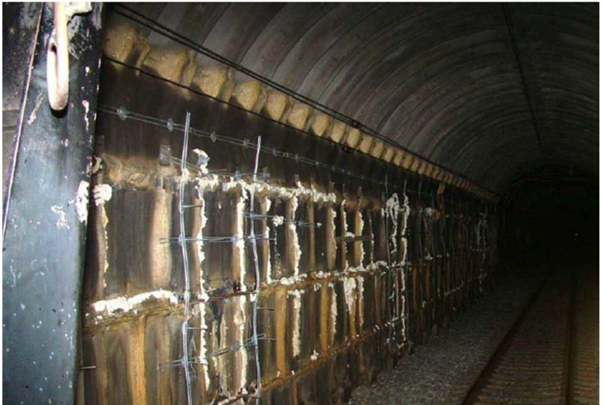
Kuva 6. Kuva holvikaarirakenteesta Tottolan tunnelissa. Pystypilareiden välissä olevat polyeteenilevyt ovat rikkoutuneet ja niitä on korjailtu. (Ratahallintokeskus 2008.)
