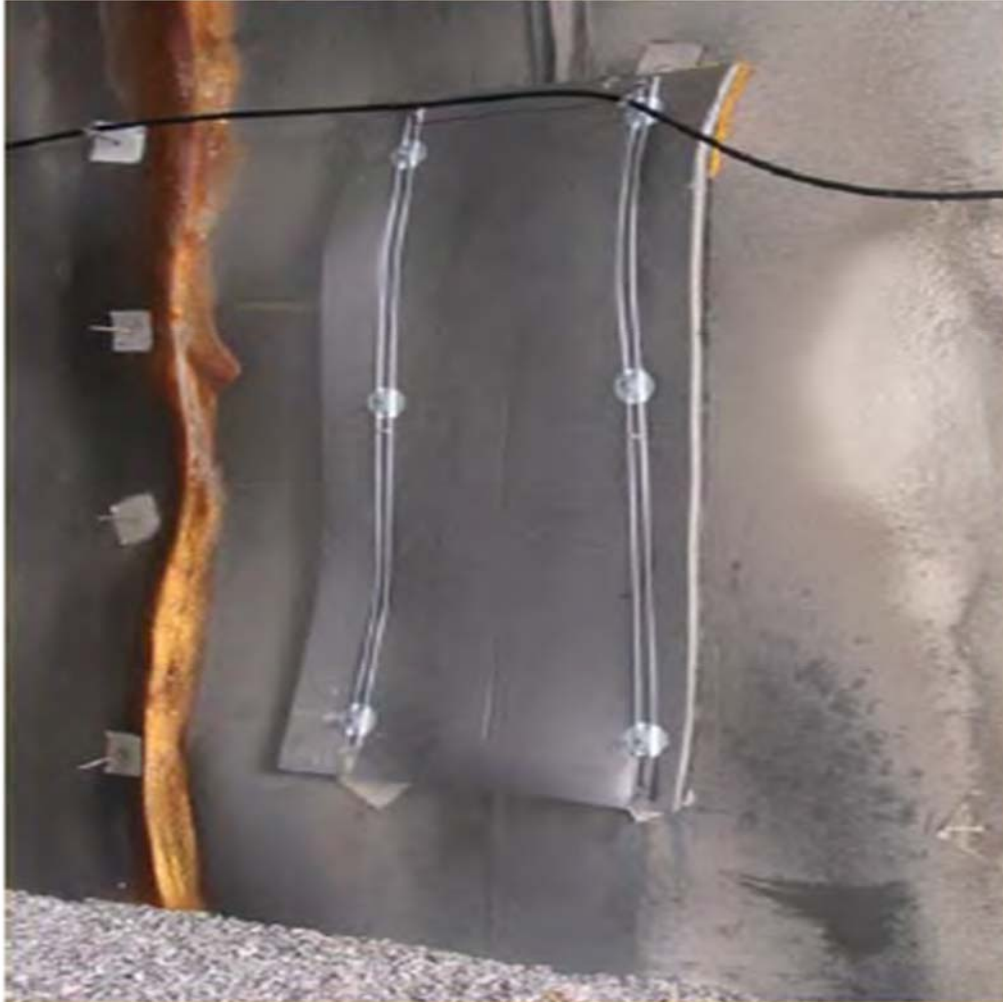
Kuva 9. Uudella PE-levyllä korjattu verhousrakenteen sauma (E. Mäkelä, henkilökohtainen tiedonanto 5.1.2015).
