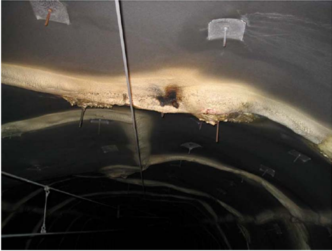
Kuva 13. Kuumentunut polyuretaanisäuma Tottolan tunnelissa (E. Mäkelä, henkilökohtainen tiedonanto 5.1.2015).
