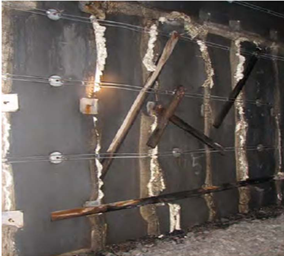
Kuva 10. Laudoilla tuettu vaurioitunut verhousrakenteen sauma (E. Mäkelä, henkilökohtainen tiedonanto 5.1.2015).
