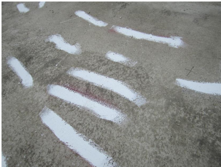
Figur 14. Ytsprickor tätas i vissa fall med tätningfärg (Ralf Wasberg)
