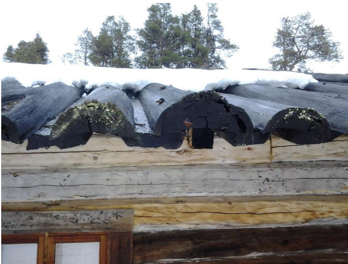
Kuva 3. Päälykellekset ovat pahoin lahonneet aluskellesten ollessa vielä hyvässä kunnossa.
