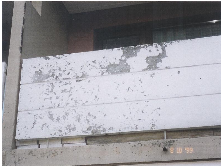
Kuva 5. Maalipinnan hilseilyä parvekekaiteissa. /1/
