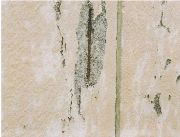
Kuva 3. Teräskorroosioaurio ja maalipinnan hilseilyä julkisivuelementin reunalla. /1/
