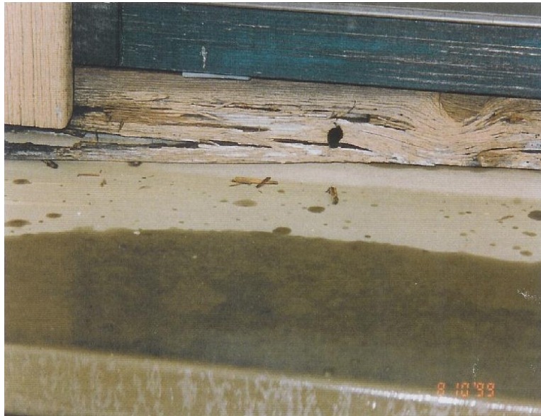
Kuva 4. Ikkunan lahonnut alakarmi. /1/
