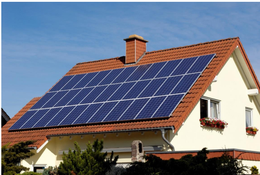
Kuva 1. Aurinkopaneelijärjestelmä asennettuna talon katolle. (Koberlein, 2015)
