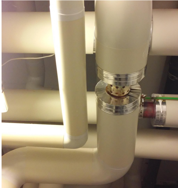
KUVIO 9. Ankkurin lämmitysjärjestelmän putkien lämmöneristys
