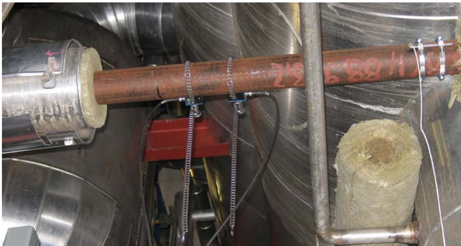
Kuva 16. Virtaus- ja lämpötilamittauspisteet RN02 putkilinjassa (kuva Markku Santikko)
