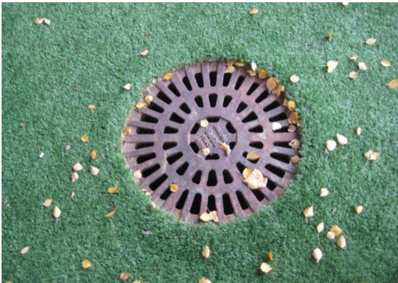
Kuva 21. Tekonurmi rajautuu siististi sadevesikaivoon. (Kirsi Paakkunainen 2014)
