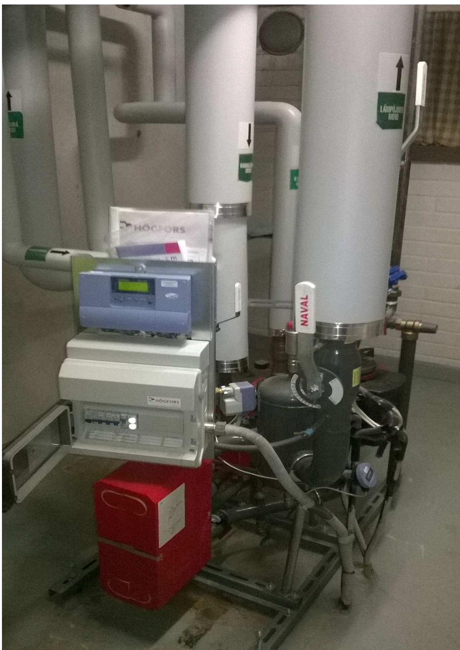
Kuva 9. As Oy Purjeentie 1:n nykyinen lämmönvaihdin.
