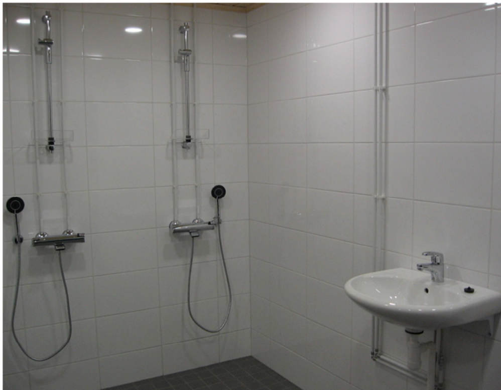
Kuva 7. Kylpyhuone komposiittiputkella (LVI Tarkkuusputki yjt:n www-sivut 2014)
