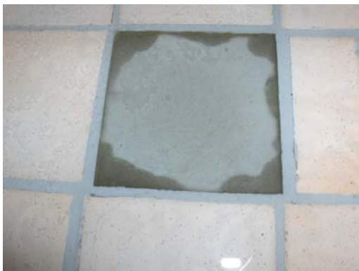
Kuva 11 Pleksilaatan alla näkyi kosteutta noin 1,5 cm:n etäisyydellä reunoista
