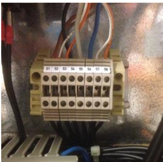
KUVA 37. Riviliittimet, josta kytkennät vietiin tehosäätimelle.
