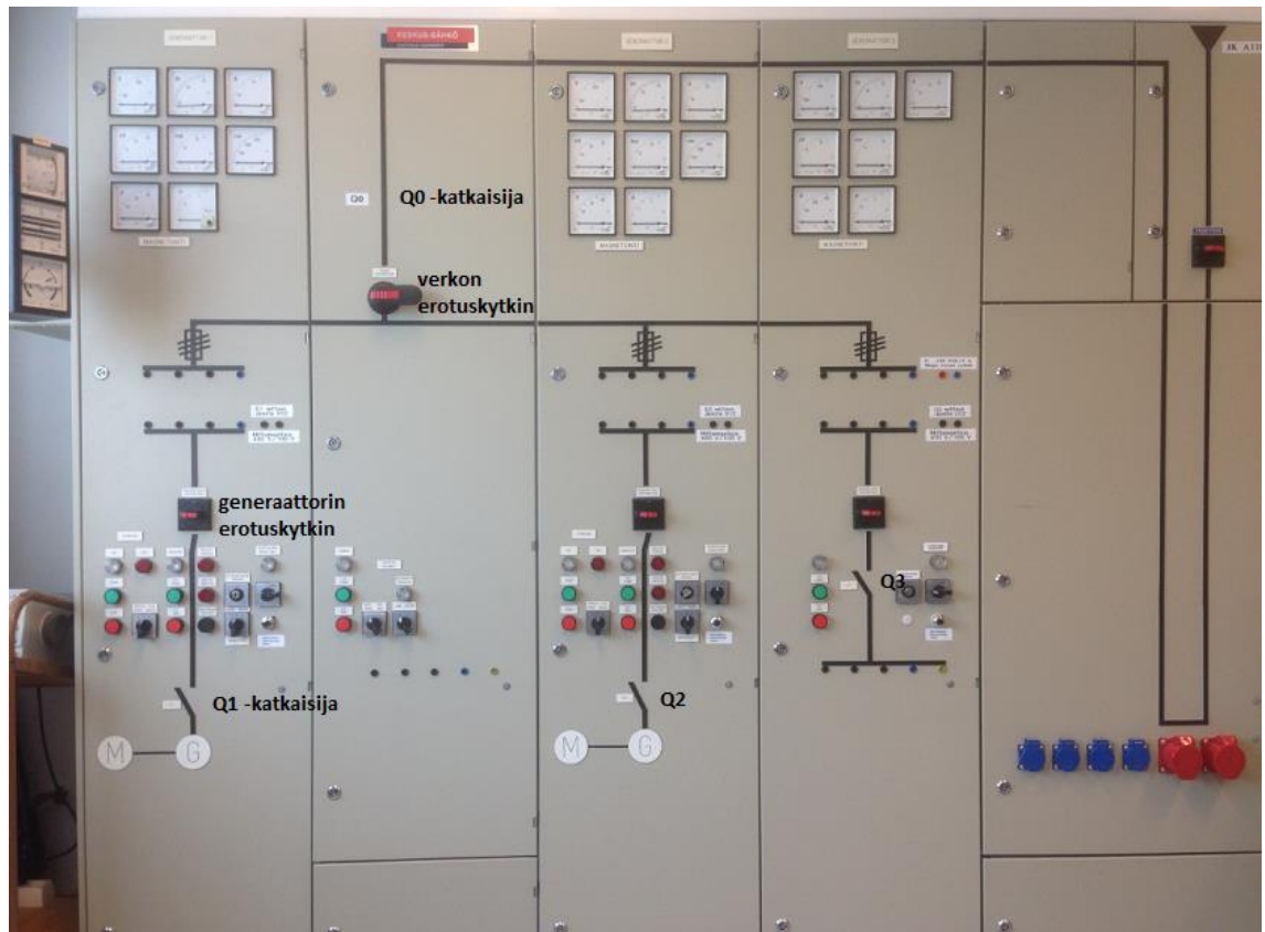
KUVA 17. TAMKIn sähkölaboratorion generaattorilaitteiston käyttöpaneeli
