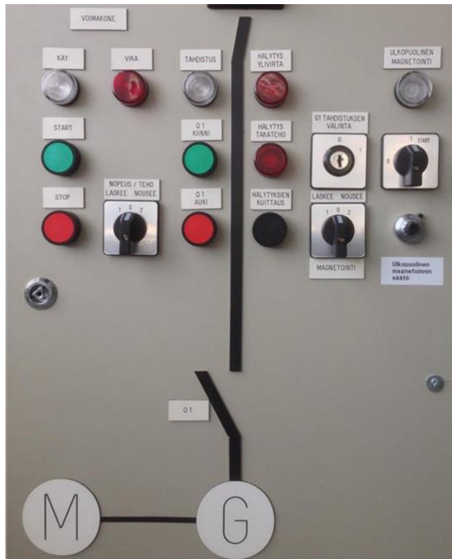
KUVA 20. Generaattorin käynnistuspainikkeet ja säätökytkimet
