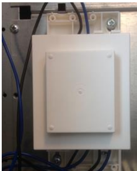
KUVA 35. Suojaerotusmuuntaja, kuva asennustilanteesta
