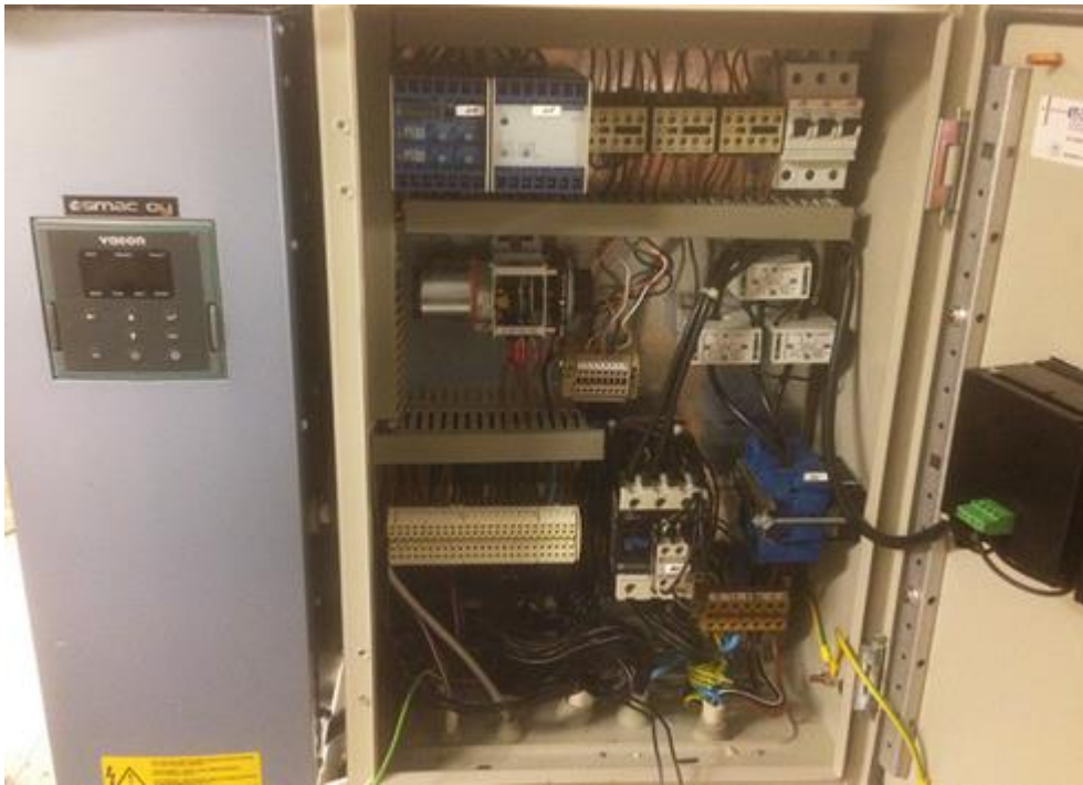
KUVA 36. Vasemmalla generaattorin 1 taajuusmuuttaja ja oikealla sähkökaappi, jossa sijaitsevat kyseisen generaattorin kytkennät.
