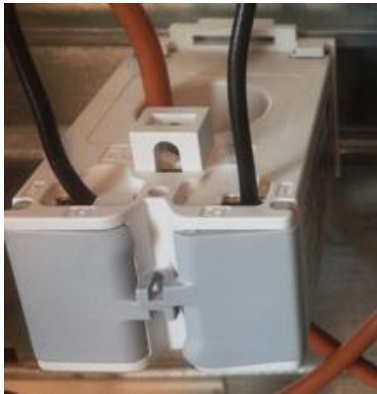
KUVA 39. Virtamuuntaja CTD-1X.50.5A.XXX, kuva asennustilanteesta
