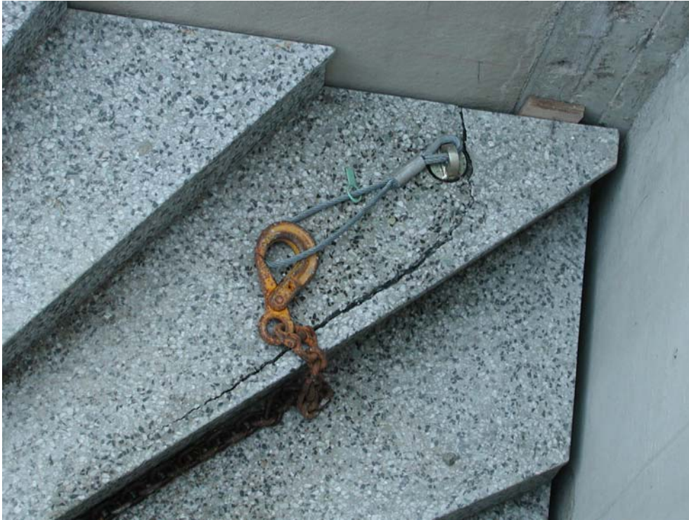
Kuva 27. Asennus on tapahtunut liian voimakkaasti.
