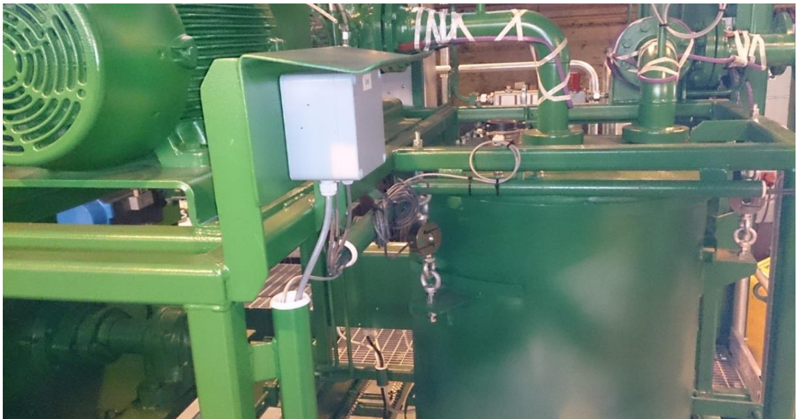
Kuva 20. Vaaka-antureiden asennusrasia, hitsattuja asennusputkia, syöttöpumpun sähkömoottori ja bitumivaaka (sylinterinmuotoinen säiliö).
