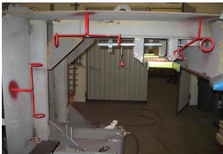
Kuva 13. Tapitushitsattuja kaapelinkannakkeita (Retco Oy).
