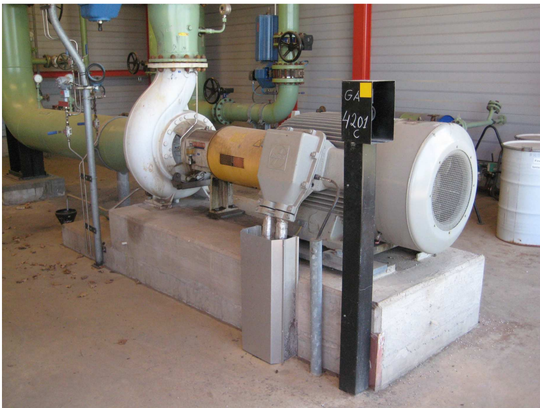
Kuva 16. Suojattava pienjännitelaitte: Suorakäyttöinen jäähdytysvesipumppu GA-4201CM. Oikosulkumoottorin nimellisteho: 250 kW.
