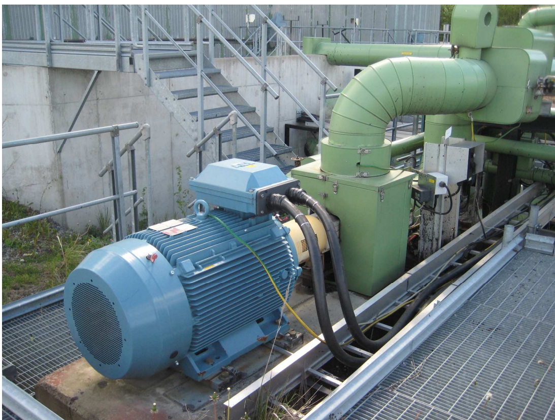
Kuva 20. Suojattava pienjännitelaitte: Taajuusmuuttajakäyttöinen raskaan polttoöljyn (POR) pumppu NGA-40 M. Oikosulkumoottorin nimellisteho: 200 kW.
