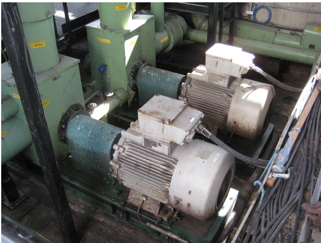
Kuva 24. Suojattava pienjännitelaitte: Taajuusmuuttajakäyttöinen raskaan kaasukondensaatin junapurkupumppu YGA-157SM.
