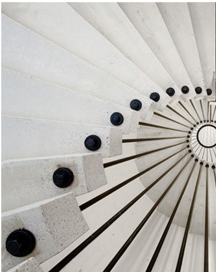
Kuva 16. Ruosteen valumajälki mosaiikkiportaassa.
