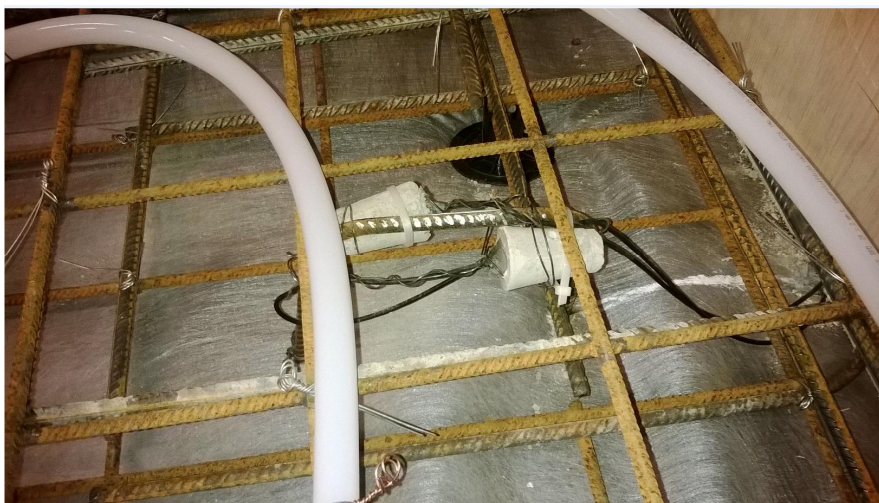
Kuva 39. Kuva työmaalle asennetusta kosteusmittausanturista
