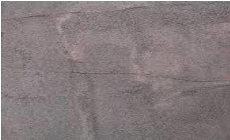
Kuva 4. Uimaranta 2 bitumikateessa oleva halkeama
