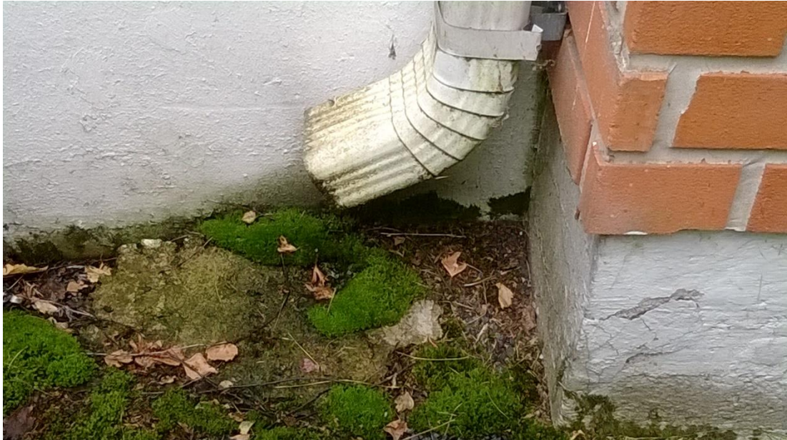
Kuva 2. Kiinteistön sadevesien poisjohdattaminen on puutteellista
