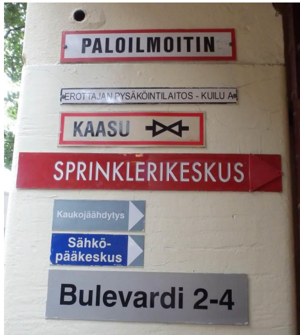
Kuva 5. Pelastuslaitoksen ulkopuoliset opasteet
