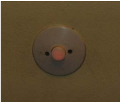
Kuva 5.20 Hohtolamppu merkkivalona käytävässä
