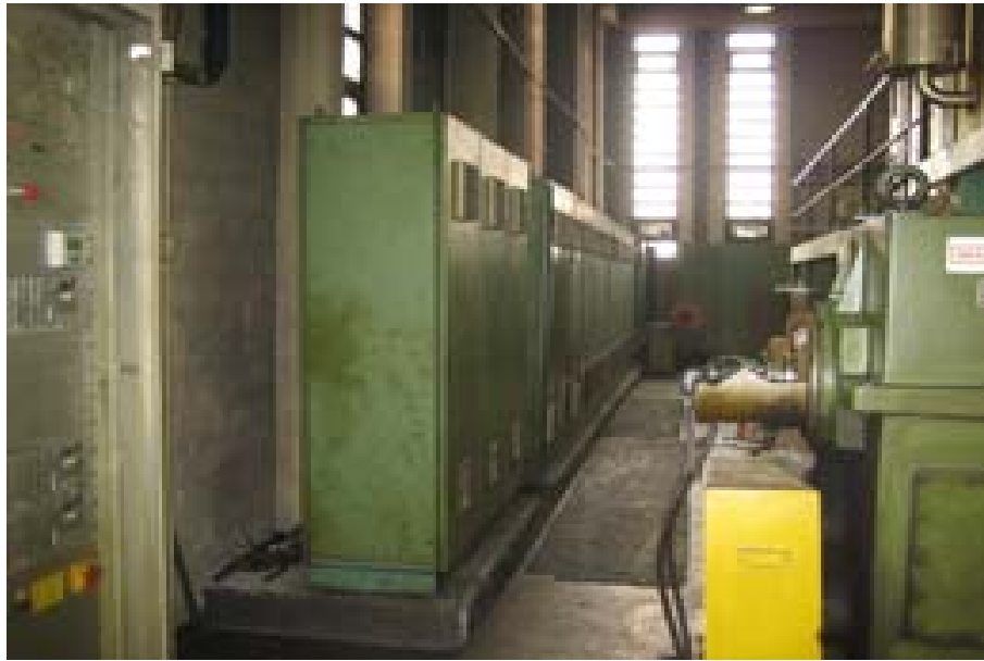
Kuva 15. Demirer Kablon vanha sähkökaappirivistö
