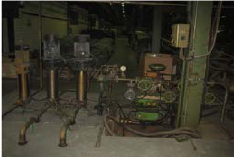
Kuva 7. Jäähdytysvesipumput ja säätöventtiilit
