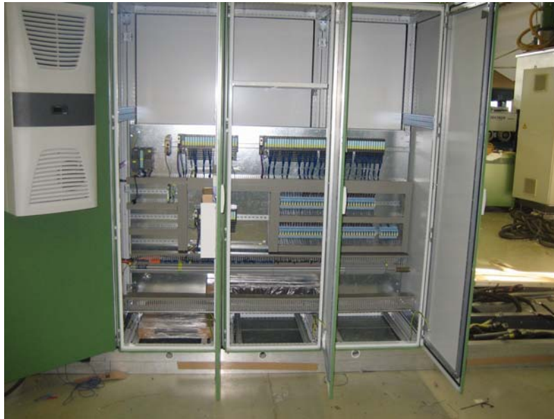
Kuva 13. Demirer Kablolle tuleva uusi linjaohjauskaappi
