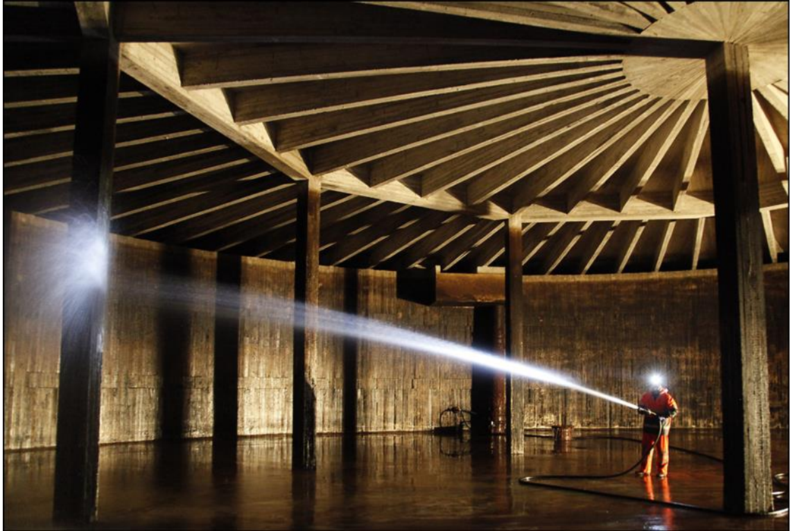
Kuva 11. Tampereen veden huoltohenkilö pesee sisäseiniä tyhjässä säiliössä. Kaupin vesitorni tai ts. ylävesisäiliö on Tampereen suurin. Sen tilavuus on noin 20 000 kuutiometriä./10./
