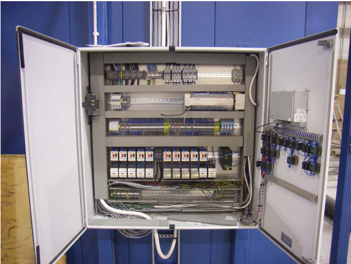
Kuva Ohjauskeskus sisältä
