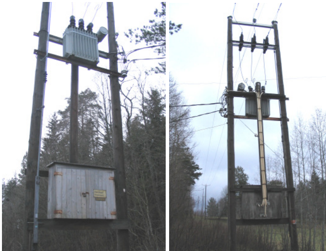
Kuva 6.9 Alestalon vuonna 1975 rakennettu 2-pylväsmuuntamo.
