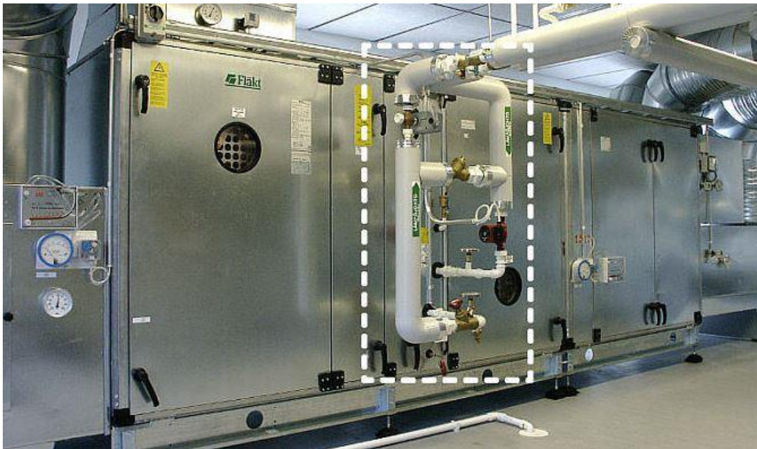
Kuva 4. Ilmanvaihtokoneen lämmityspatteri (Talotekniikan opetussivusto www-sivut 2015).
