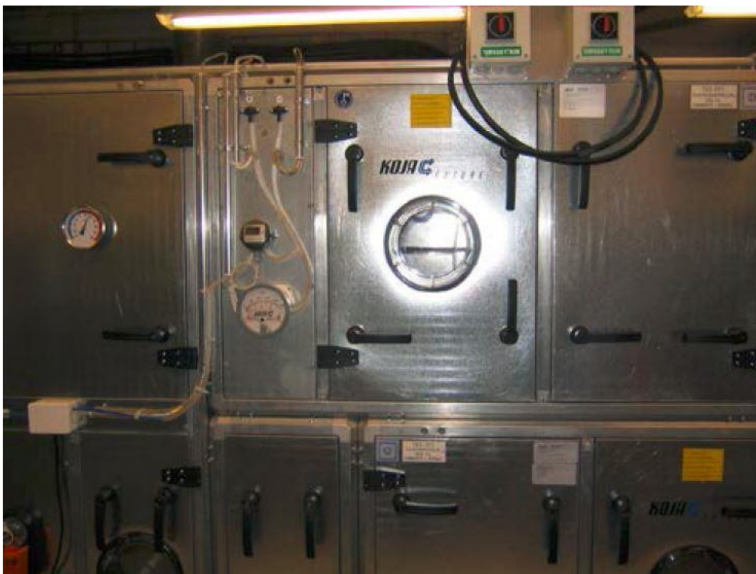
Kuva 2. Ilmanvaihtokone ulkoapäin (Sulvi www-sivut 2015).
